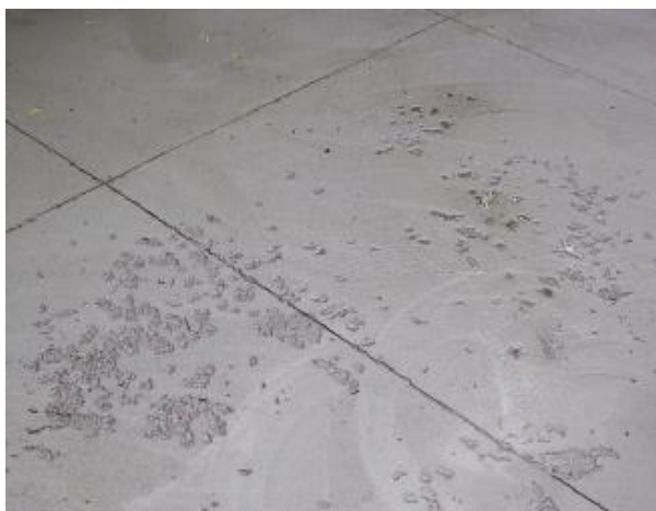
a- Écaillage modéré d'une dalle de béton
