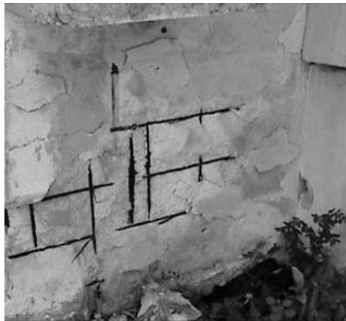
Figure (I-1) : Exemple de fissures causées par la carbonatation, Romel et al (2008).
