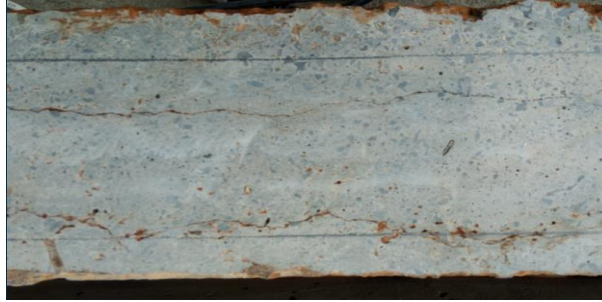
Figure (V-19) : Exemple des fissures longitudinales (poutre PC15P)
