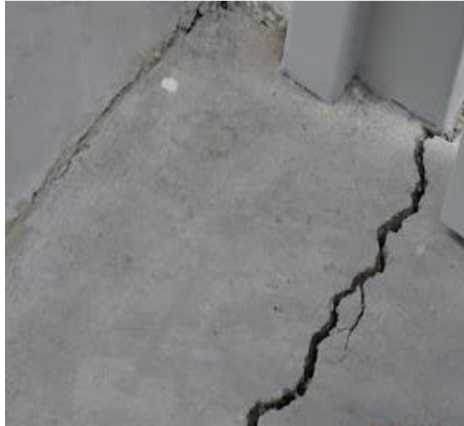
Figure (I-13) ; Exemple d'une fissuration par un retrait empêché, (AUDIXOL).
