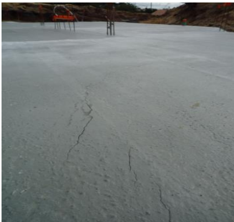
Figure (I-12) : Exemple des fissures provoquées par un retrait plastique, (photo extraite de site de forumconstruire).
