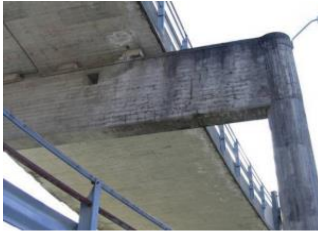
Figure (I-8) : Exemple d'un faïençage dans un pont affecté par RAG, AAR (2013).
