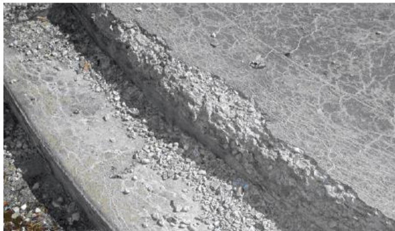
Figure (I-10) : Fissuration interne due par l'action des cycles de gel-dégel, Gayné et al (2008).
