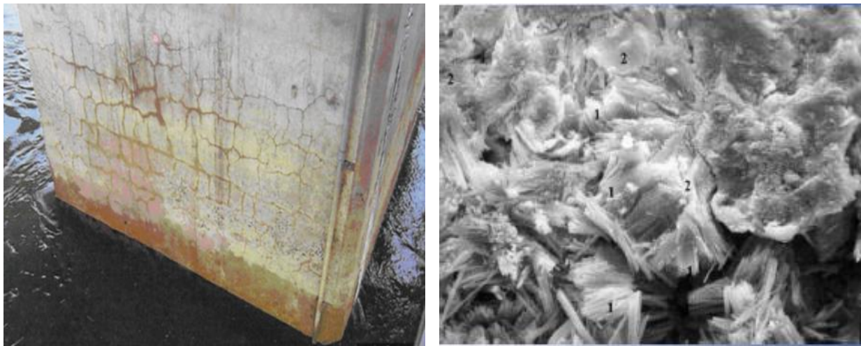
Figure (I-6) : Réseau des fissures dans un pont endommagé par RSI, Divet (2003).
