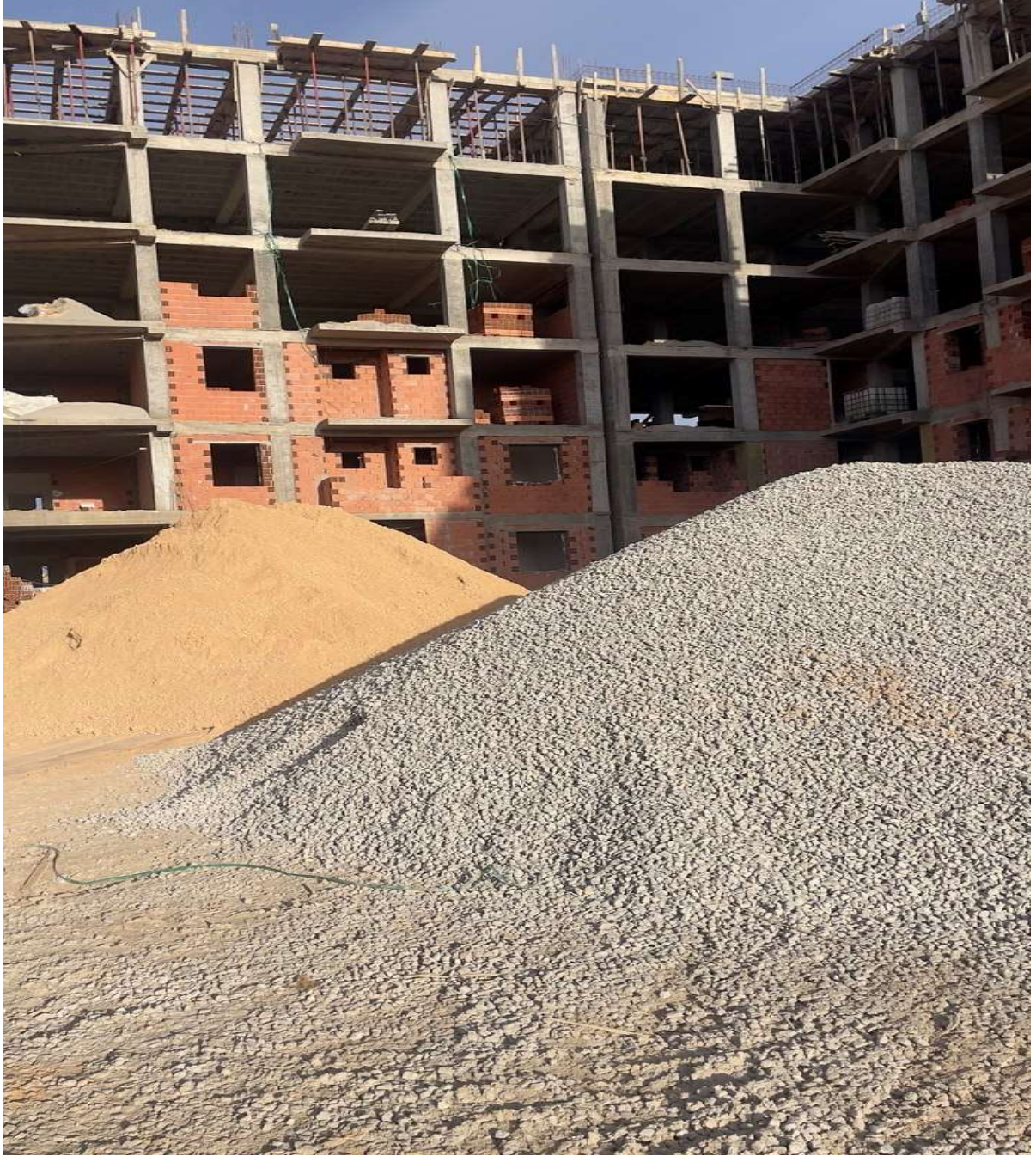
الملحق 04 صورة تمثل سوء تخزين مواد البناء على مستوى الورشة
