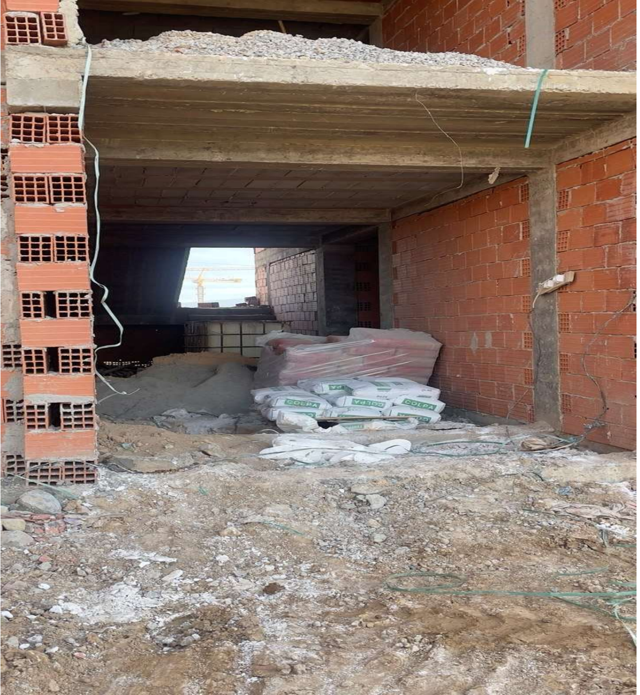
الملحق 05: صورة تمثل سوء تخزين مواد البناء على مستوى الورشة
