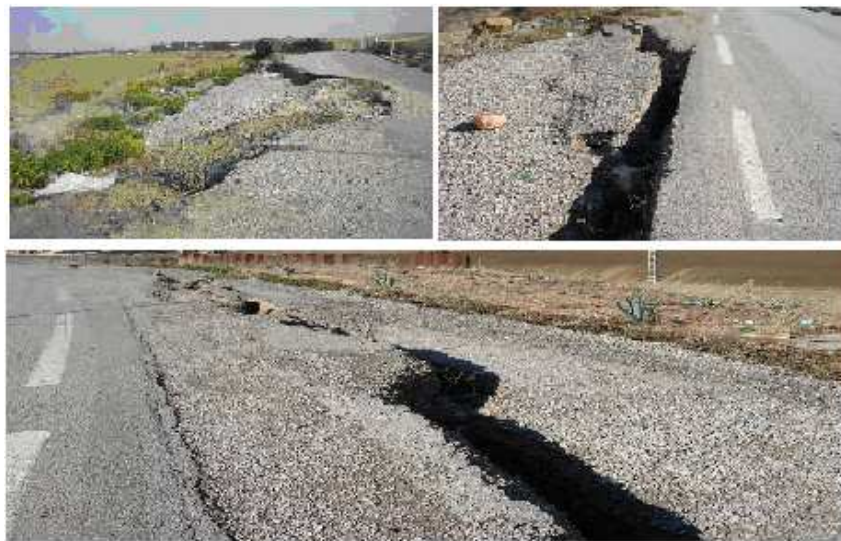
Figure III.17 : Quelques dégradations observés dans la zone E [38]
