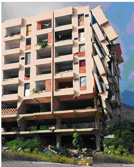
c. Construction partiellement détruite, Seca Venezuela 1999, [www.answers.com].
