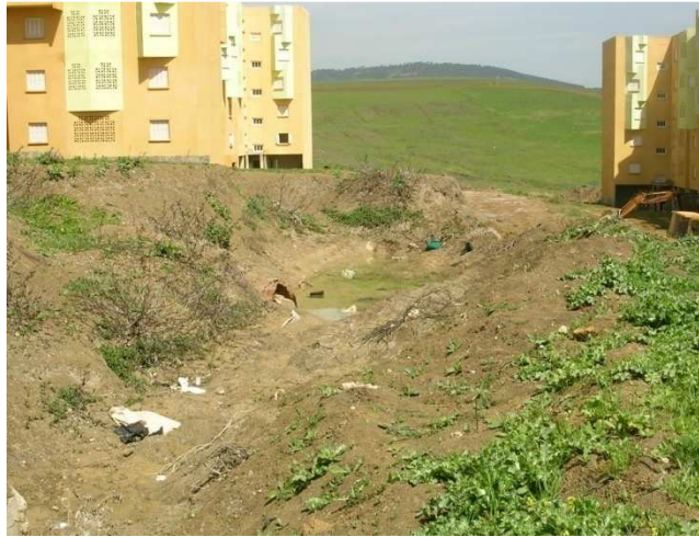
a. Stagnation d'eau qui sature un remblai
