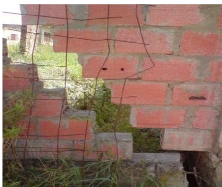
a. Glissement à Ouled Amieur, Jijel Algérie.
