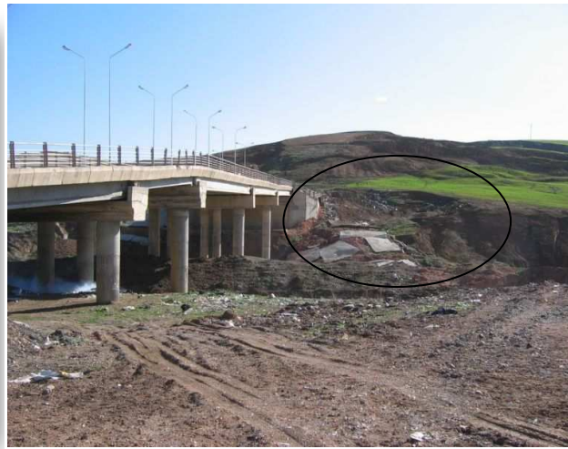
Dégradation de la culée rive droite du pont de franchissement du Rhumel, par glissement du versant amont argileux. (route de Massinissa).
