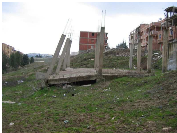
Figure III.11 : Destruction d'une maison en cours de construction par suite d'évolution d'un glissement de terrain [36b].
