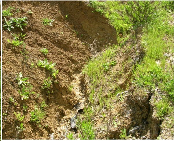
b. L'eau de ruissellement crée des rigoles qui provoquent une érosion régressive des talus.
