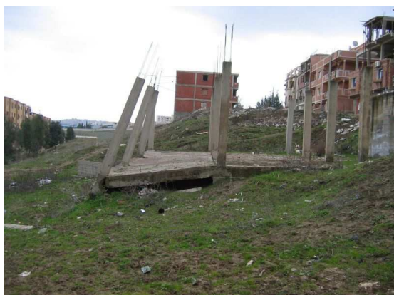
Destruction d'une maison en cours de construction, par suite d'évolution d'un glissement de terrain.
