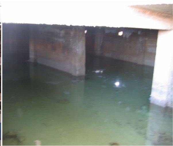
d. Sous sol de bâtiment constamment inondé, baignant dans la nappe superficielle des argiles décomprimées miocènes
