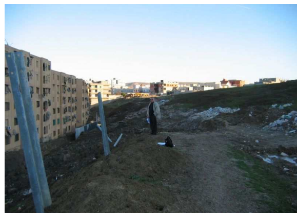
Un grand glissement très actif menace directement des immeubles.
