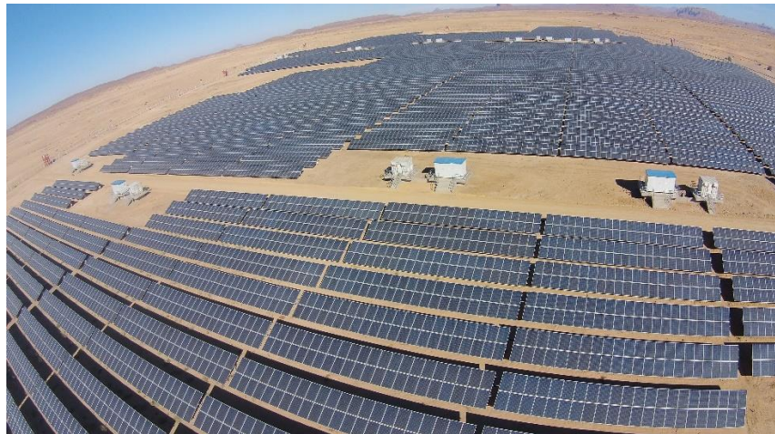
Figure IV.7. Centrale solaire photovoltaïque de Tamanrasset.
