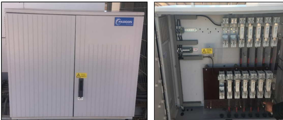
Figure III.3 : La boîte centrale à l'intérieur.
