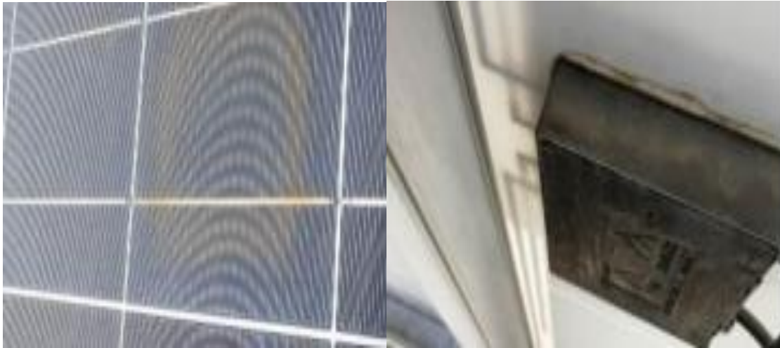
Figure I.10 : (a) Vue avant du cas de point chaud de type cellule à polarisation inverse et (b) Vue arrière du cas de point chaud de type résistance série [45].
