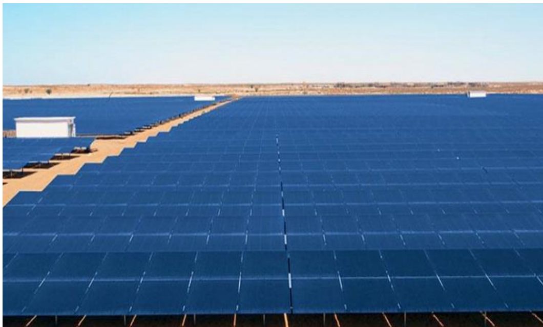
Figure. II.1 : Vue de la centrale solaire photovoltaïque de Sheikh Zayed[78].
