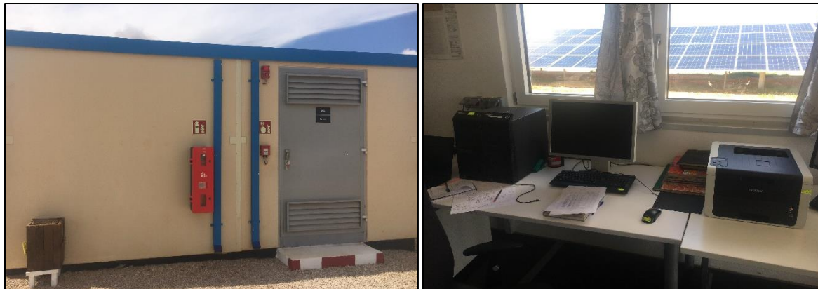
Figure III.6 : La salle de contrôle.
