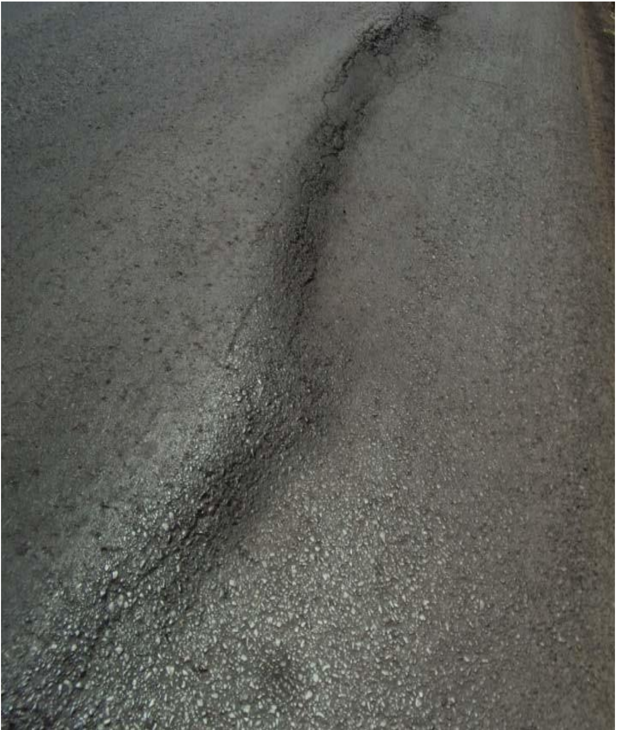
Figure AI.5 photographie d'affaissement
