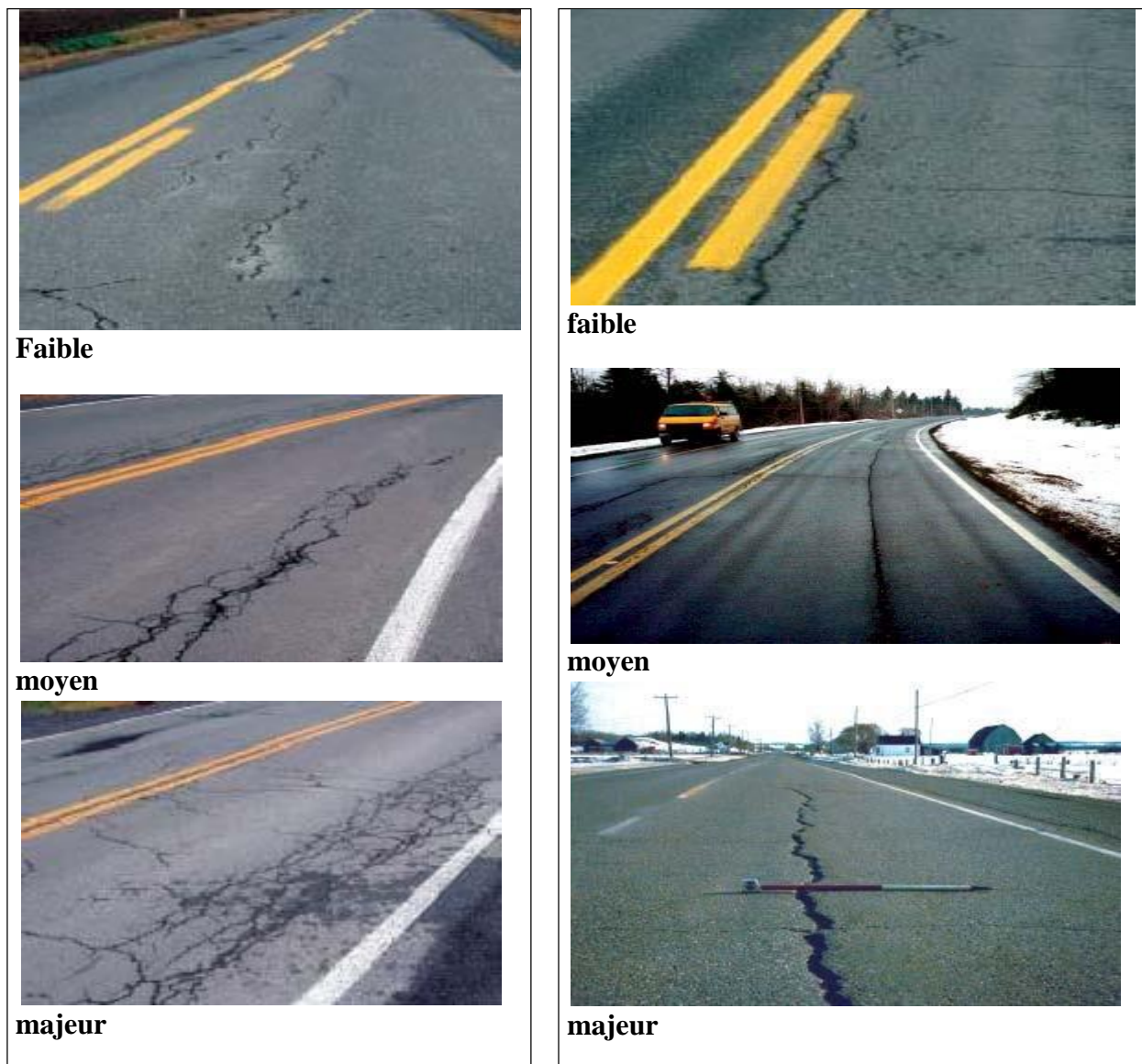
a. Fissures longitudinales en piste de roues) b.Fissures longitudinales hors piste de roues)
