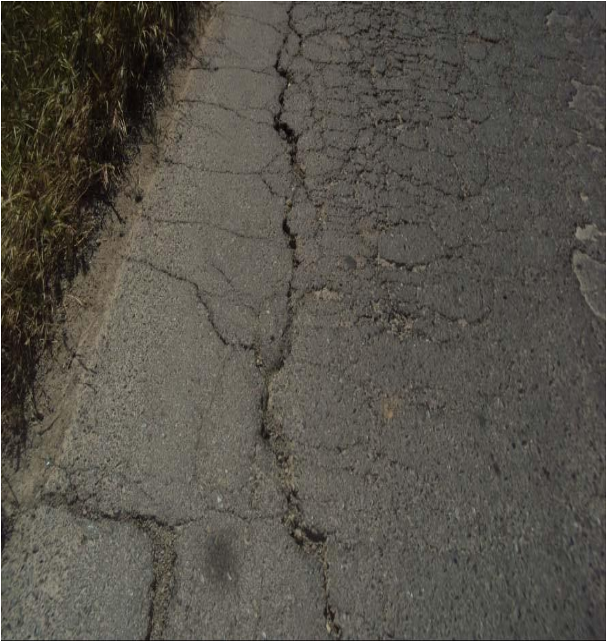
Figure AI.2 photographie de fissures longitudinales
