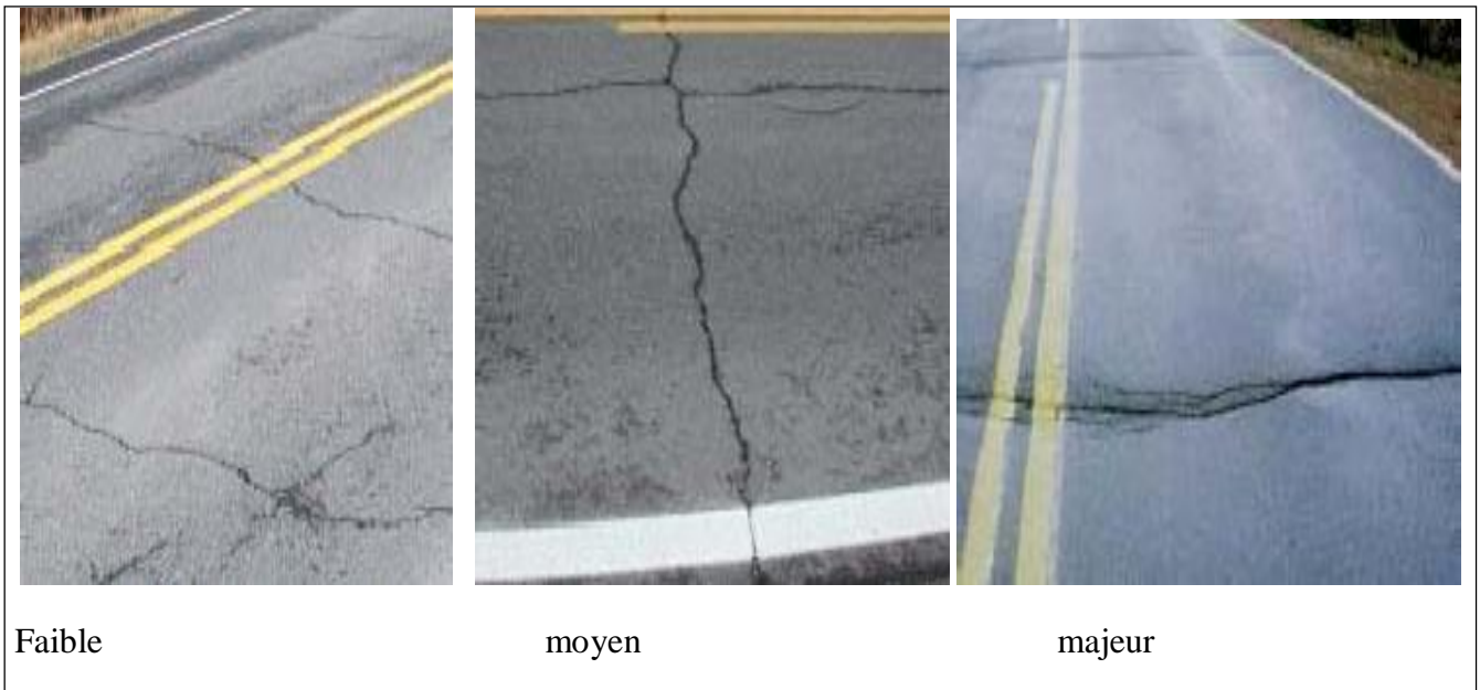
a. Fissures transversales
