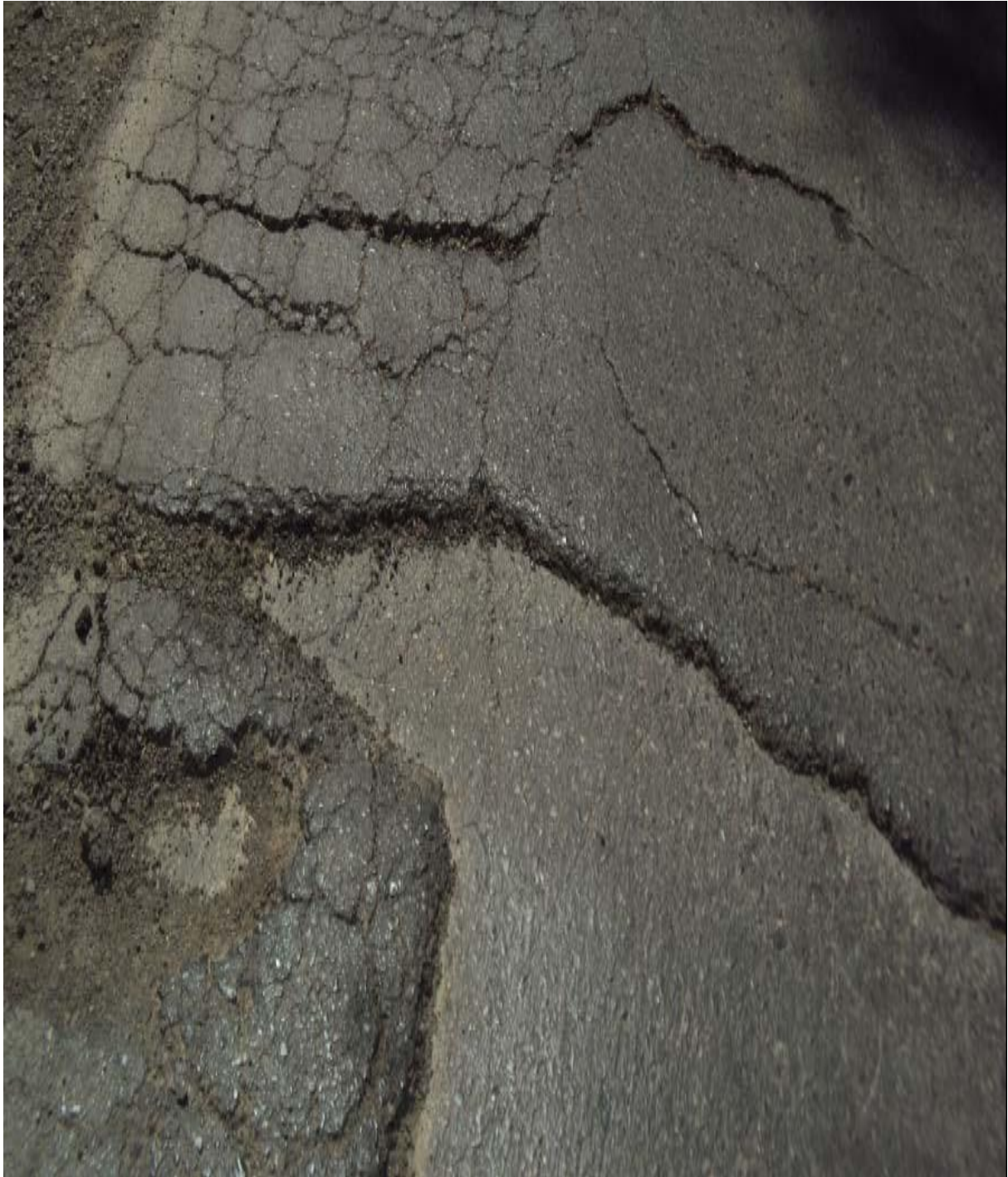
Figure AI.1 photographie de fissures transversales
