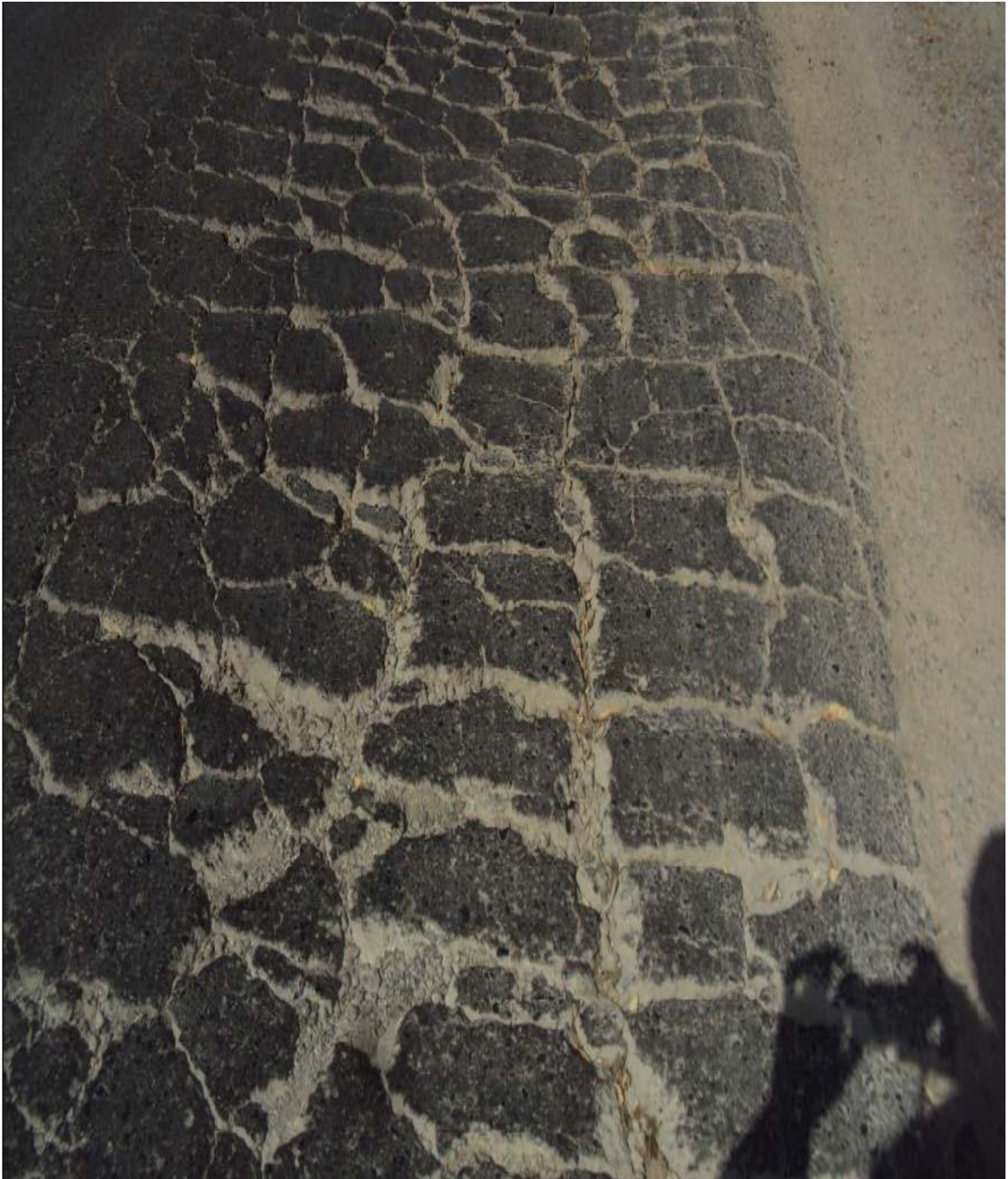
Figure AI.3 photographie de faïençages à mailles fines
