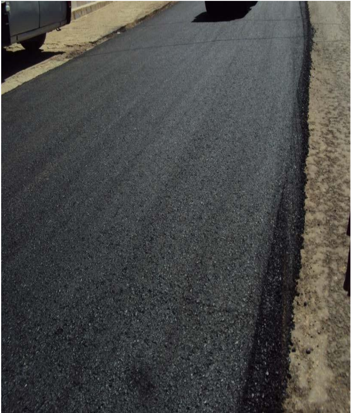
Figure AI.6 photographie de cas de renforcement en béton bitumineux de la chaussée
