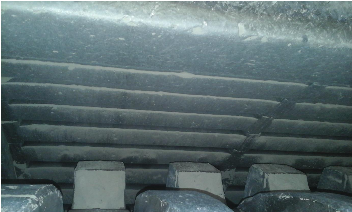
Fig. grille de sortie usée.
