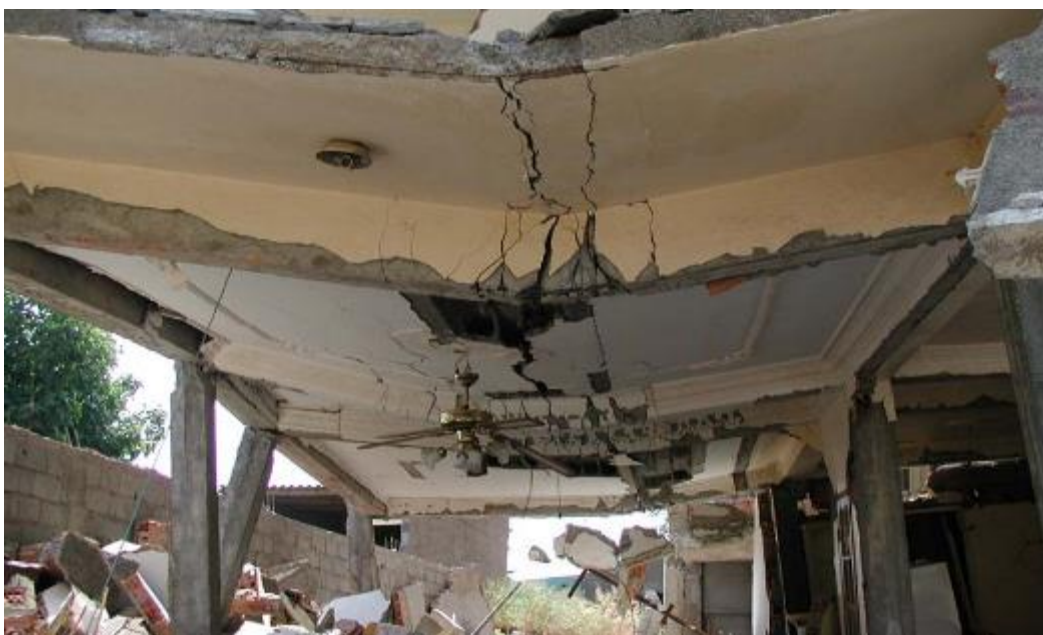
Figure III.11 : Rupture par flexion des poutres[48]
