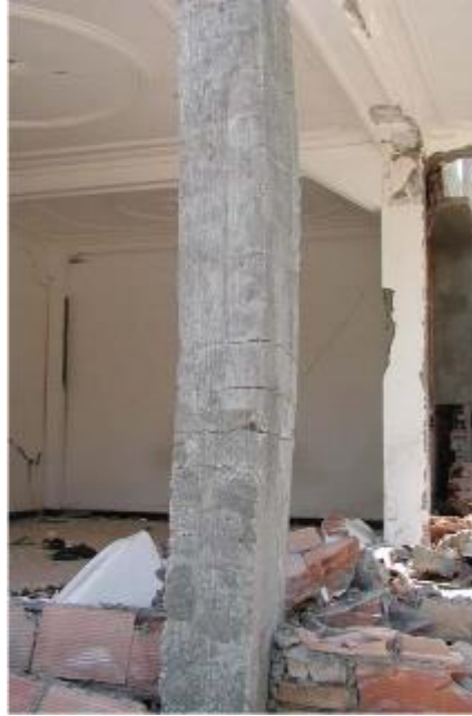
Figure III.10 : Flambement de poteaux[48]
