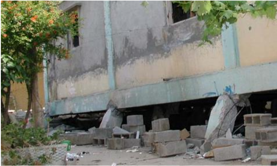
Figure III.8 : Dommages dus aux poteaux courts dus au vide sanitaire[48]
