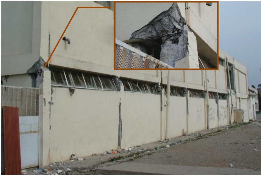
Figure III.7 : Cas de poteaux courts sans protection – tous les poteaux sont cisailés[48]
