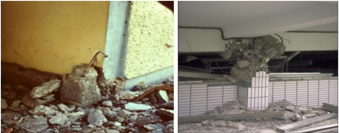
Figure III.21 : Dommages dus à l'effet de poteau court en vide sanitaire et dû à la présence d'allèges en maçonnerie dans la structure principale en portiques[1]
