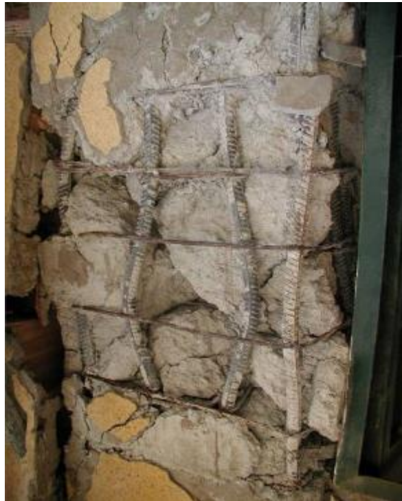
Figure III.9 : Ecrasement du béton et flambement des aciers dans les poteaux dans l'escalier[48]
