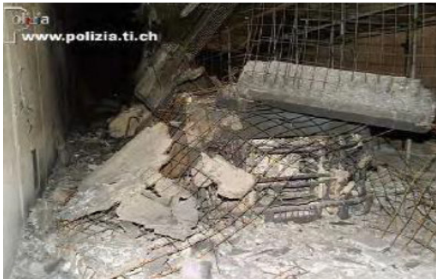
Figure. II. 2 : Section effondrée du faux plafond dans le tunnel du Gothard après l'incendie du 21 octobre, 2001
