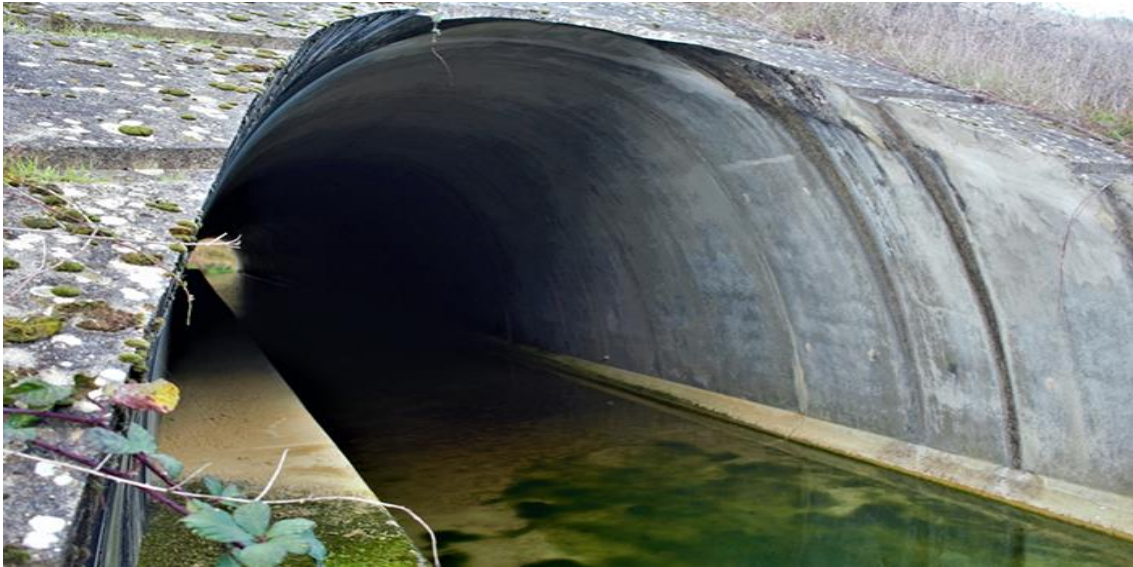
Figure 06 : En France, un ponceau traverse une autoroute. L'aménagement d'un banc du côté gauche a pour objectif de rendre l'utilisation de ce passage plus accessible aux petits mammifères tels que les loutres, les blaireaux, les martres et les renards. (Andréa ,2012)
