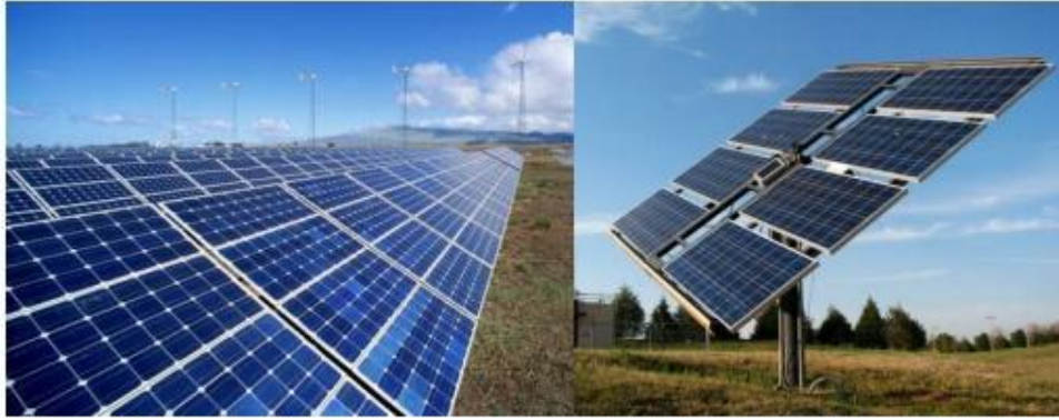
Figure (I.17) : Panneau photovoltaïque.
