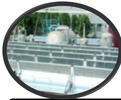
الصورة رقم (04): نظام تبريد المبنى
