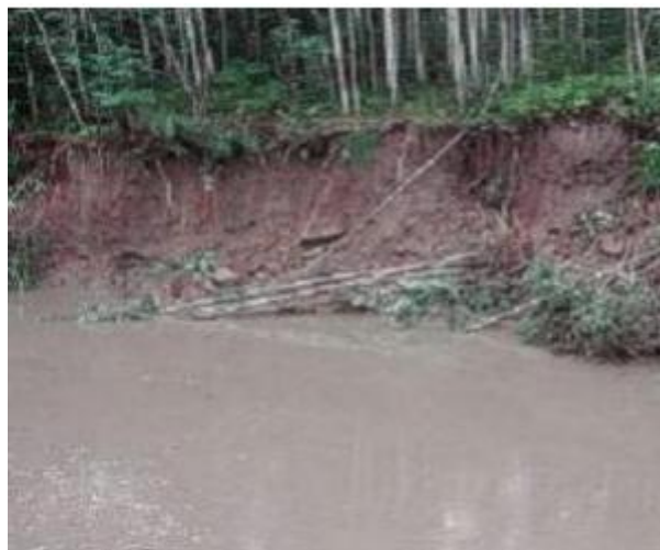
Figure II.5: Érosion des berges par le cours d'eau d'une rivière
