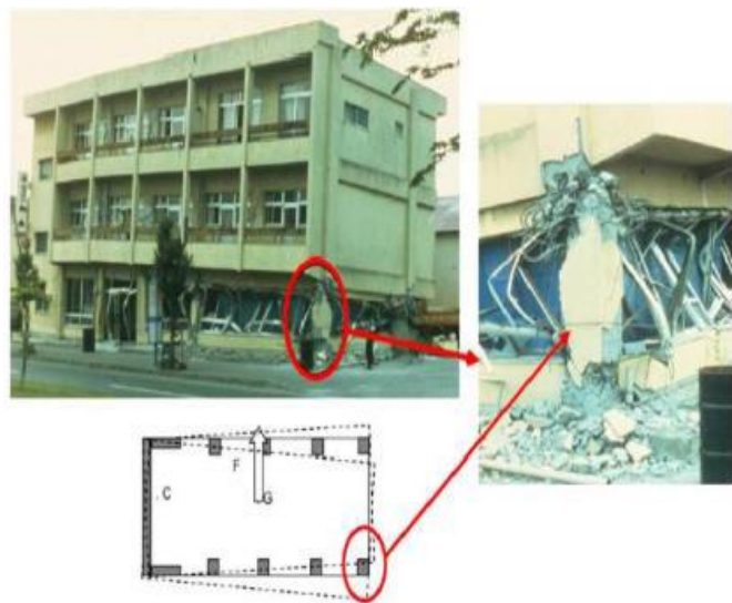
Figure II.16: Plastification d'un poteau d'angle due à la position asymétrique des voiles [1]
