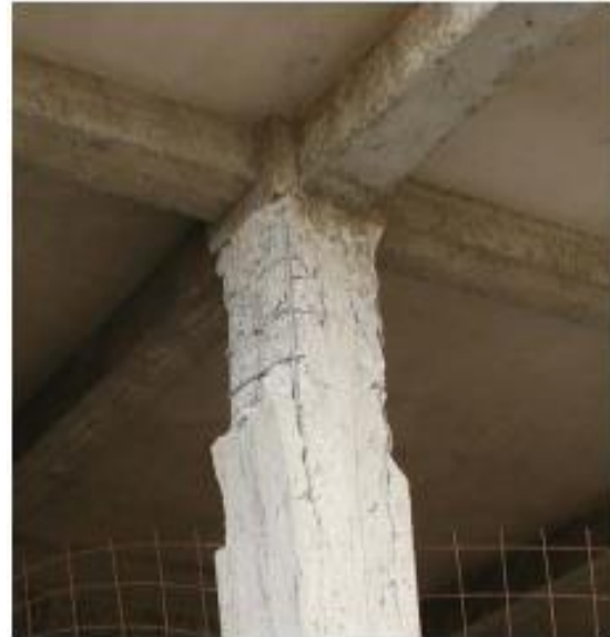
Figure II.10 : Décollement de l'enrobage [7]
