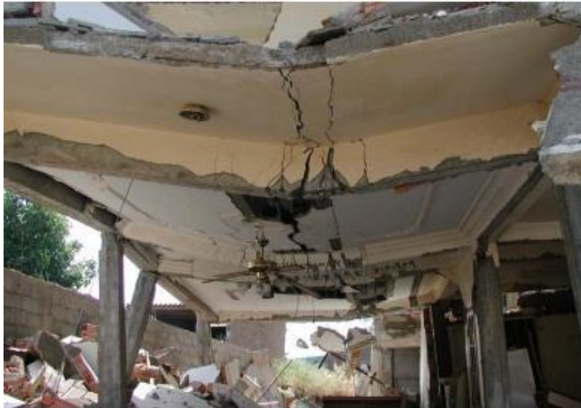
Figure II.11 Rupture par flexion des poutres [7]
