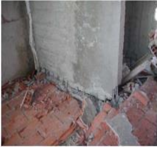
Figure II.13 Rupture de section à la base des voiles [7]
