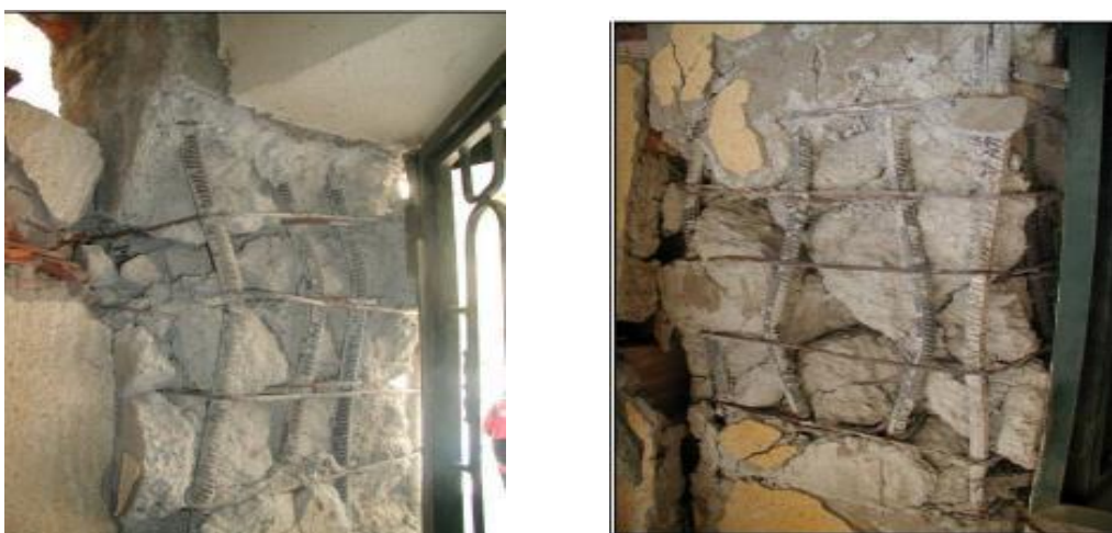
Figure II.8 : Ecrasement de béton et flambement des aciers dans les deux poteaux de la cage d'escaliers [7]
