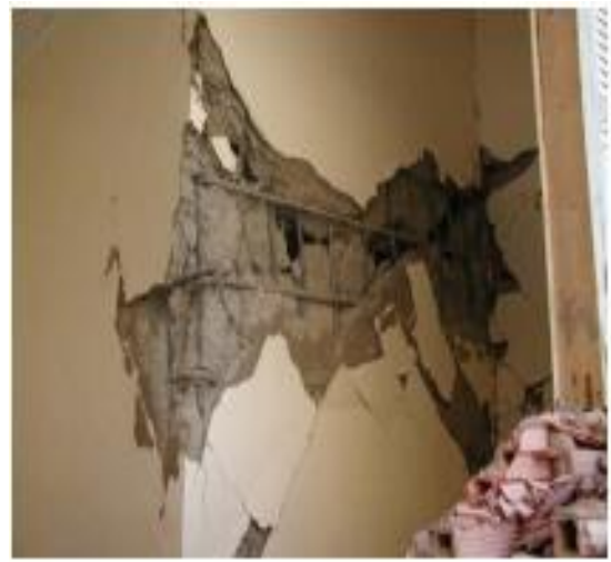
Figure II.14 Fissures ouvertes dans le voile [7].
