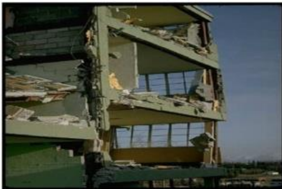
Figure II.12 Dislocation des remplissages de maçonnerie [1]
