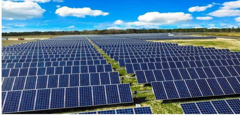
الشكل I-01: محطة ألواح شمسية لتحويل الطاقة الشمسية إلى كهربائية
