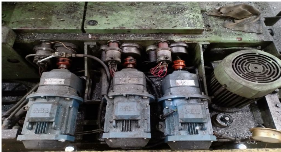
Figure IV-9: le remplacement de la pompe de l'huile par trois moteurs asynchrones
