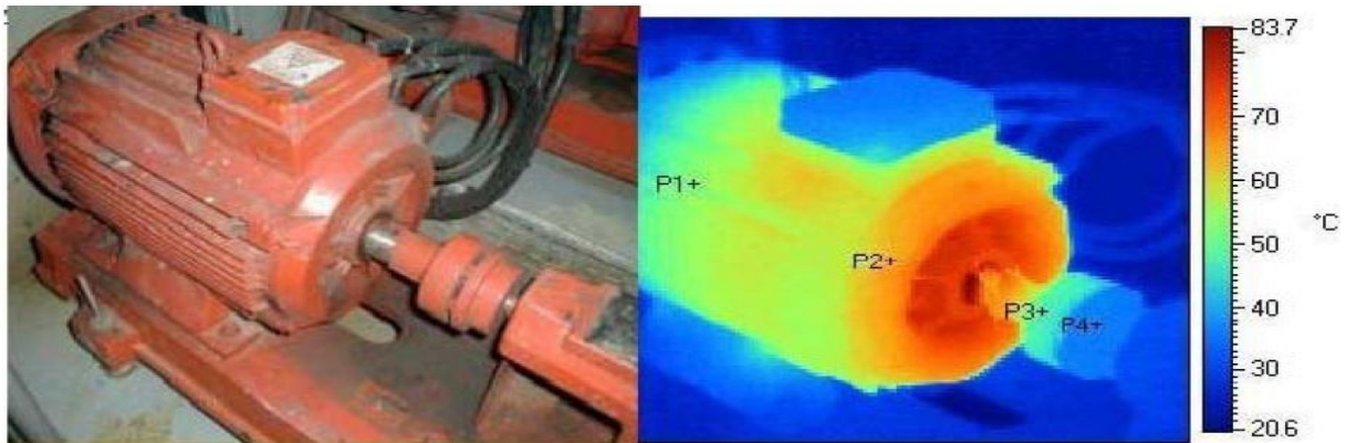
Figure I-26-Défaut de roulement
