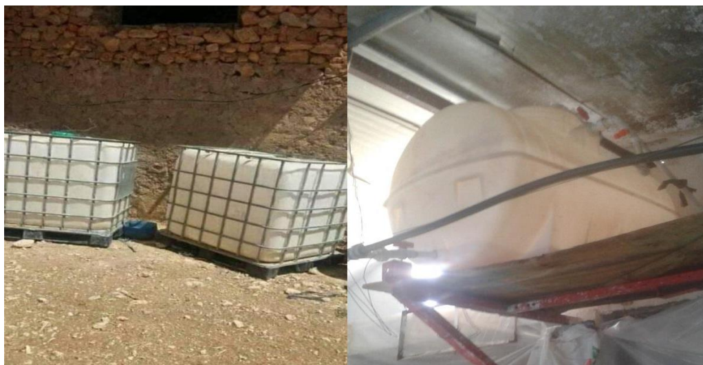
Figure 23: Citernes de stockage de l'eau
