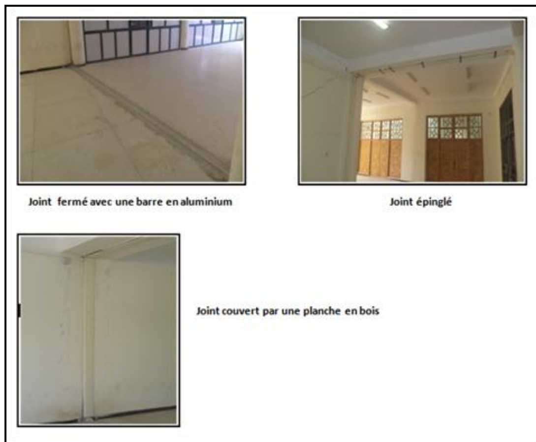
Photo III.17 : Exemples de joints traités de façon ne respectant pas les normes techniques.
