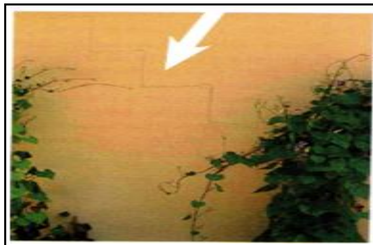
Figure I.11 : L'angle de cette maison s'est enfoncé. la fissure qui s'est ouverte suit les joints de la maçonnerie.
