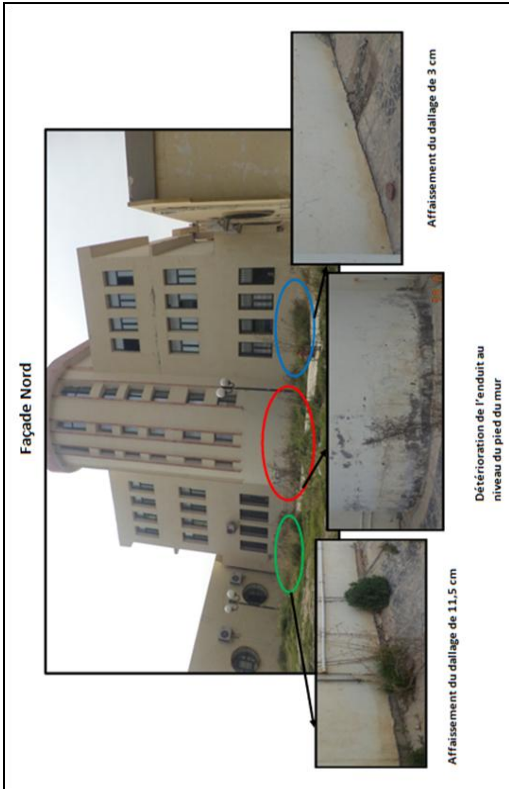
Photo II.9 : Désordres observés dans la façade Nord.
