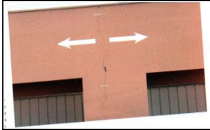
Figure I.12 : Cet acrotère s'est dilaté, une fissure s'est ouverte à mi-longueur de la façade.
