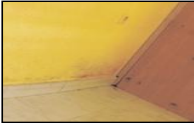
Figure I.42 : La tache est foncée et persistante et se trouve tout le long d'un mur de cave ou de rez-de-chaussée sans cave. [19]
