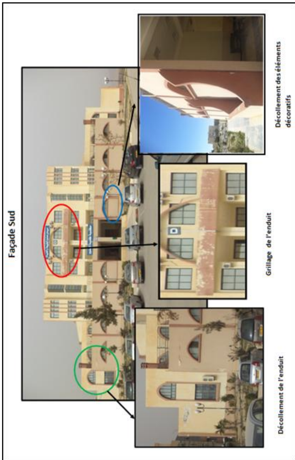
Photo II.1.3 : Désordres observés dans la façade Sud.
