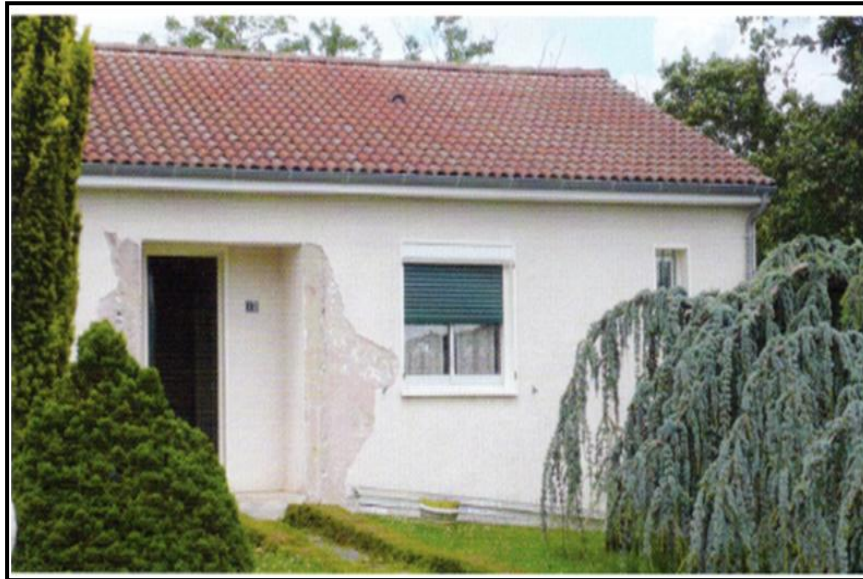
Figure I.34 : L'enduit de façade, projeté sans précautions sur un support lisse se détache. [2]
