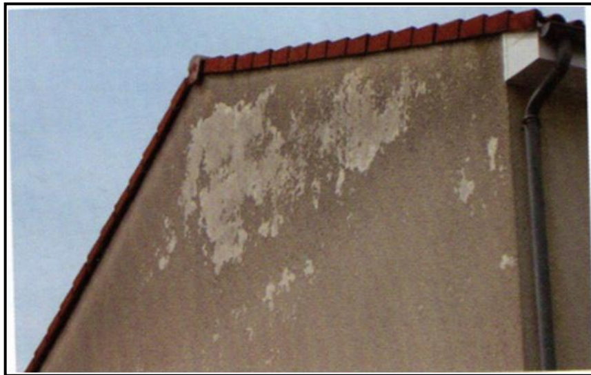
Figure I.36 : La couche de finition de cet enduit traditionnel a grillé au soleil. [2]
