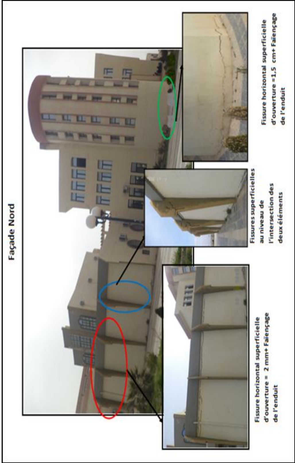
Photo II.10 : Désordres observés dans la façade Nord.
