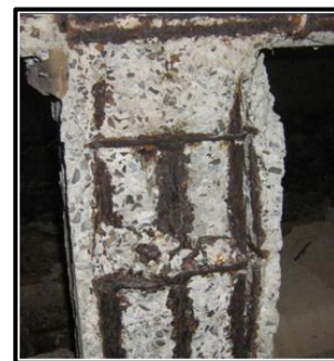
Figure I.22 : Corrosion des amorces poteaux. [16]
