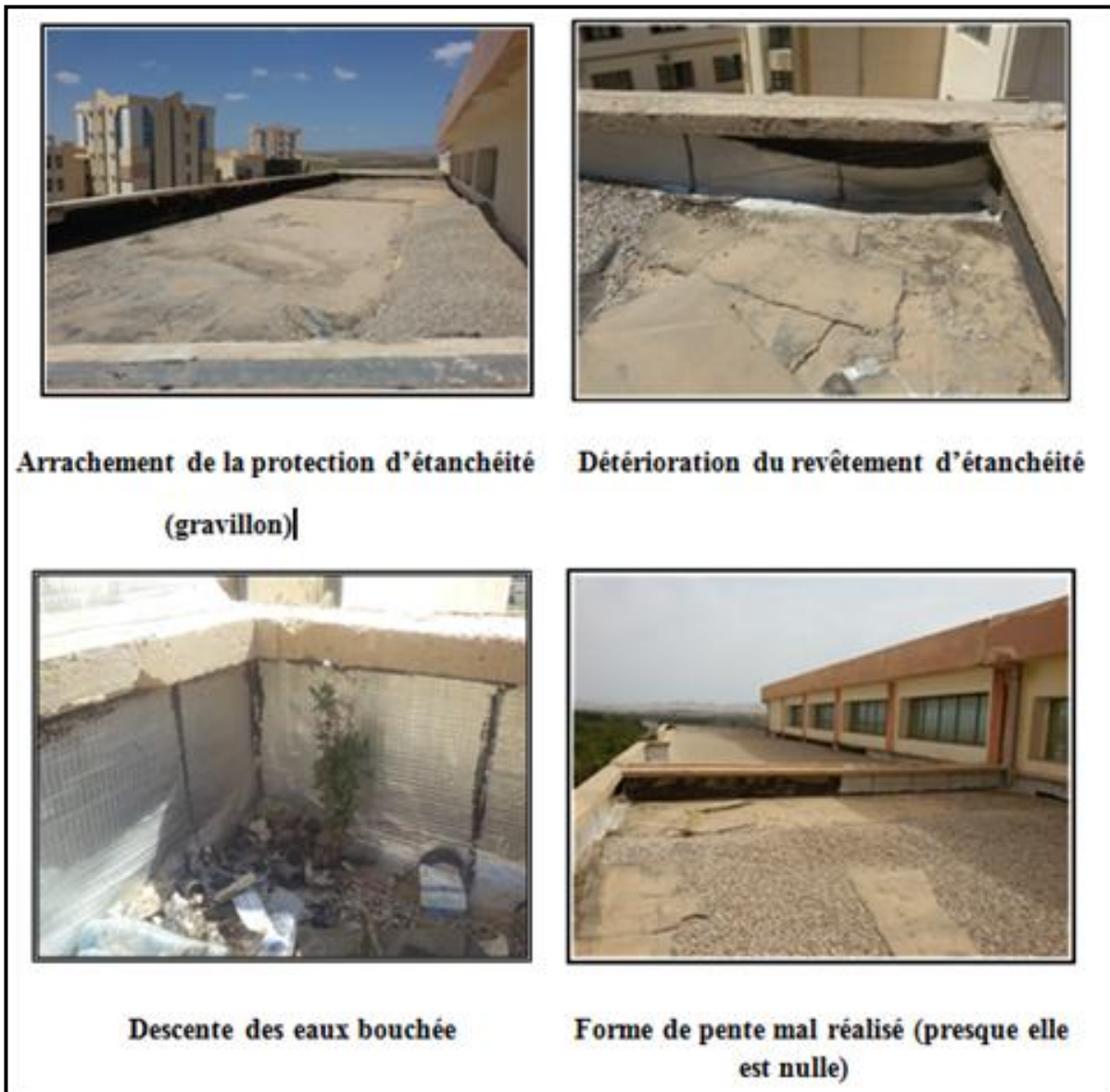
Photo III.18 : Exemples de défauts d'étanchéité.
