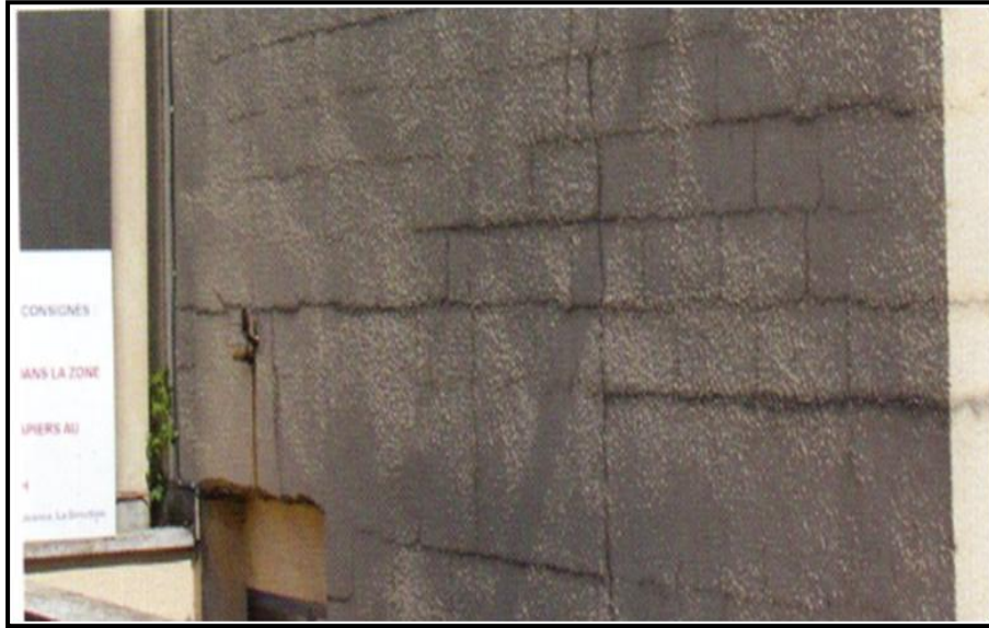
Figure I.31 : Des fissures se sont ouvertes le long des joints de cette maçonnerie, la pluie stagne dans les fissure et permet le développement de lichens. [2]
