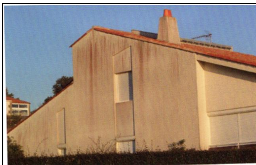
Figure I.33 : Salissures d'un enduit d'un enduit de façade par la pluie qui contient un micro-organisme. [2]
