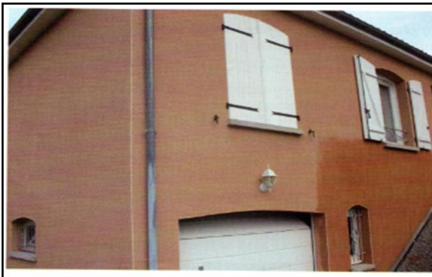
Figure I.35 : Un test d'arrosage a été effectué sur cette façade moderne afin d'apprécier la porosité de l'enduit. [2]
