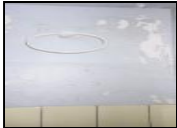
Figure I.39 : Dégradation de la peinture d'un mur intérieur. Gonflement et chute par écailles. [19]
