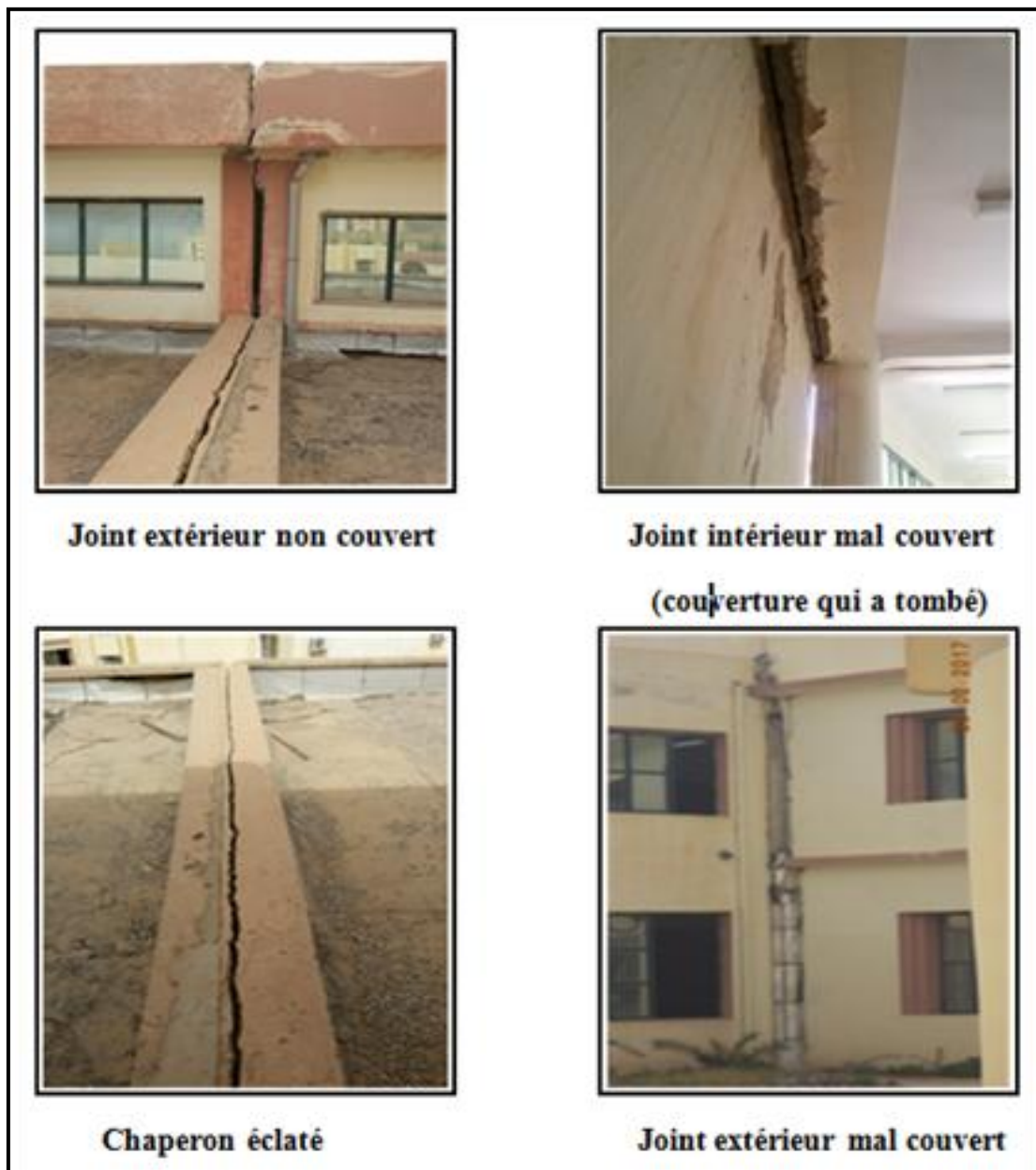
Photo III.19 : Exemples de joints ne respectant pas les normes techniques.
