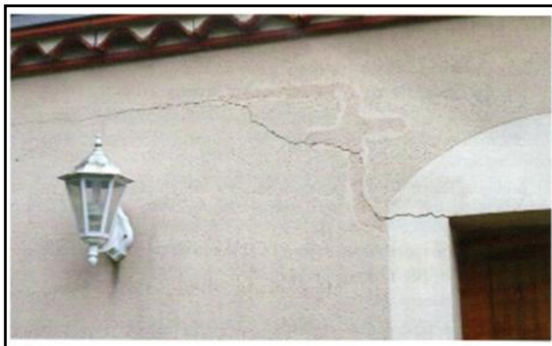
Figure I.5 : Une première fissure a été rebouchée, cette réparation a servi de témoin. L'apparition d'une nouvelle fissure conduit à mieux appréhender la pathologie.
