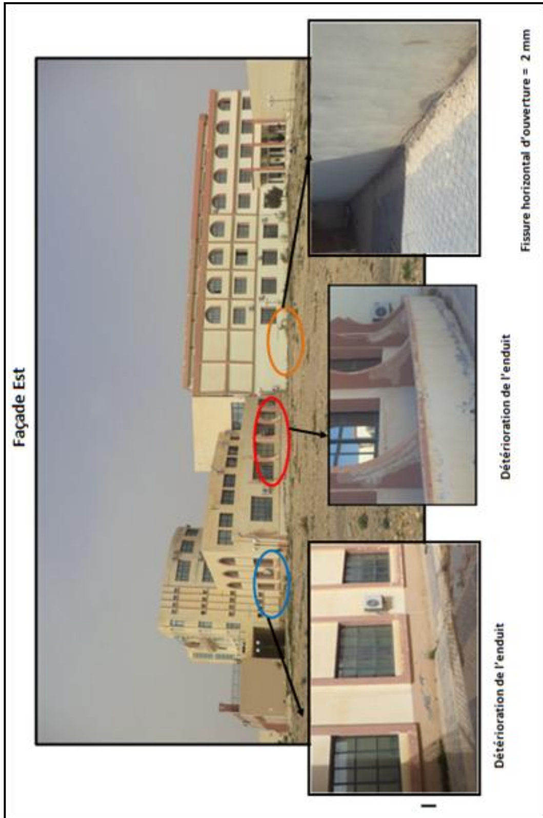
Photo II.1.14 : Désordres observés dans la façade Est.
