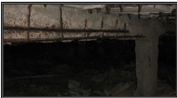
Figure I.21 : Effondrement du béton d'enrobage avancé avec l'apparition des armatures très corrodées. [16]
