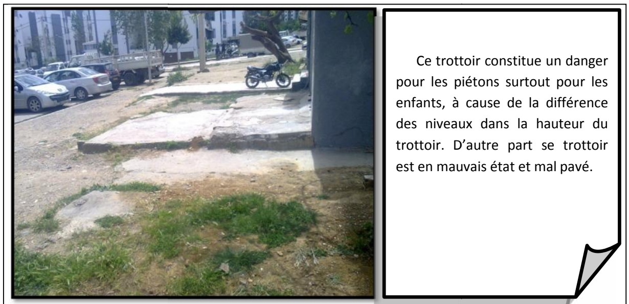
Photographie n° 2 : trottoir dégradé dans la cité des frères SETTAR:
