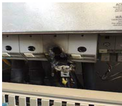
Fig 25.exemple défaut système cablage
