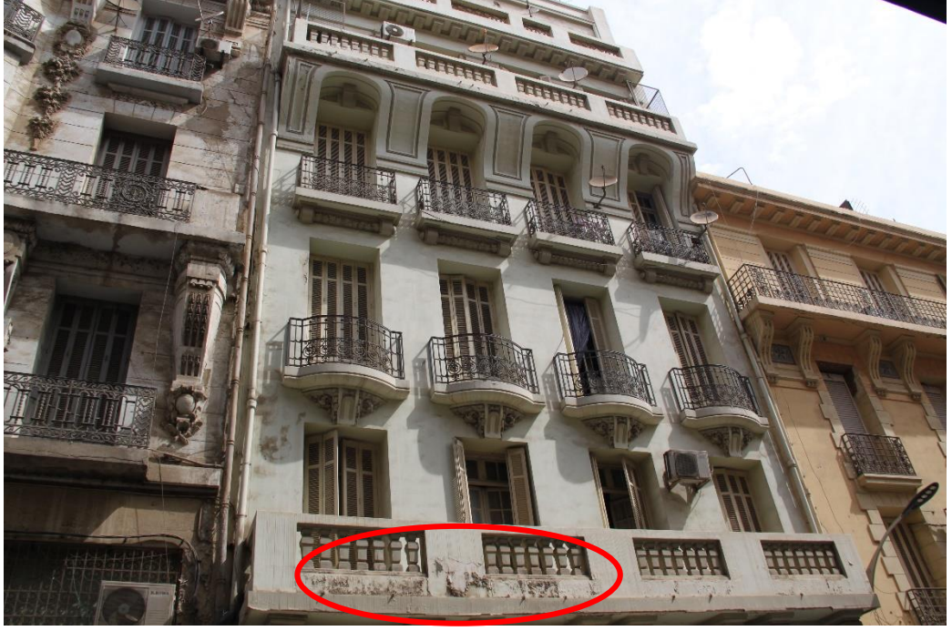
الصورة (104) توضح تدهور واجهة البناية بعد الترميم
