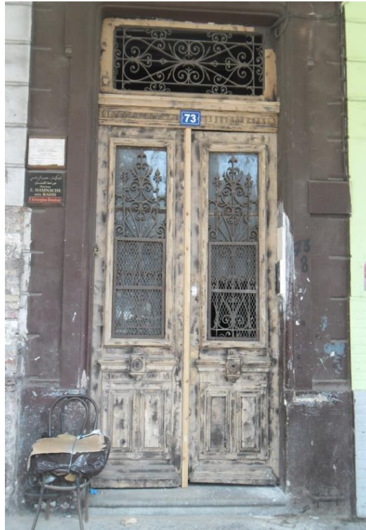
الصورة (66) توضح حالة مدخل لبناية بالشارع الرئيسي لعربي بن مهدي
