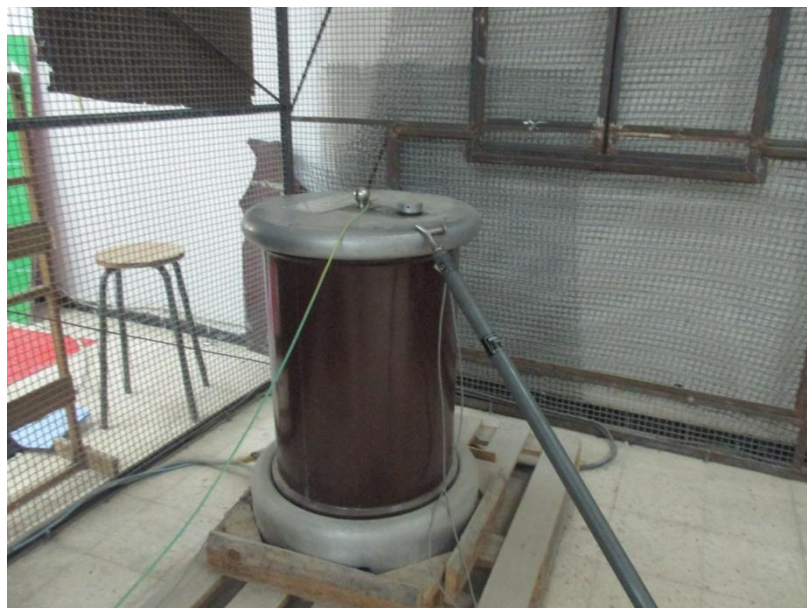
Figure III.5.Laboratoire : le transformateur et la perche
