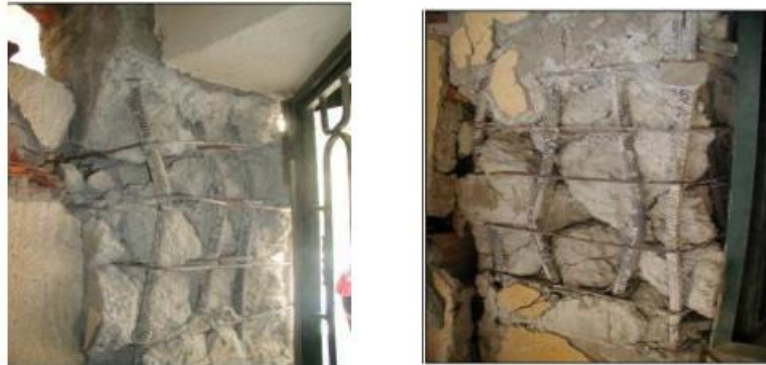
Figure III.7 : Écrasement de béton et flambement des aciers dans les deux poteaux de la cage d'escaliers [40]
