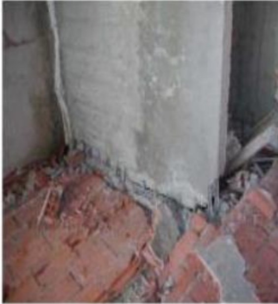
Figure II.14 : Rupture de section à la base des voiles [43]
