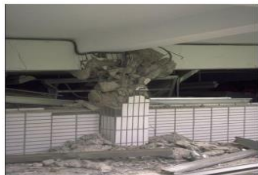
Figure III.6 : Dommages dus à court en vide sanitaire et dû à la présence d'allèges en maçonnerie [53]
