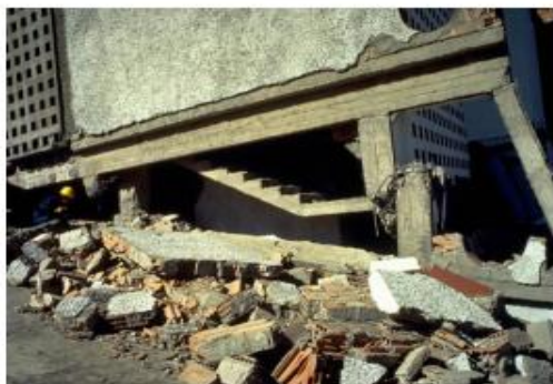
Figure III.5 : L'effet de poteau court dû à l'effet de poteau D'un palier d'escalier et la solution. [53]
