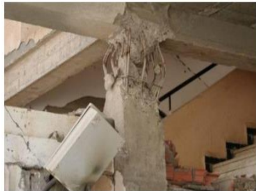
Figure III.2 : Flambement des barres et rupture par cisaillement d'un poteau en béton Armé Séisme de Boumerdes, Algérie 2003). [54]
