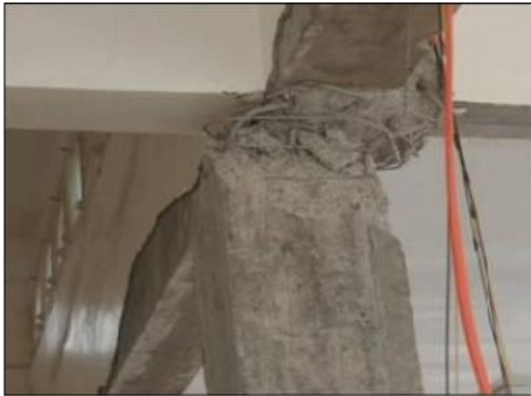
Figure III.1: Ruine d'un poteau court (Séisme de Boumerdes, Algérie, 2003). [54]
