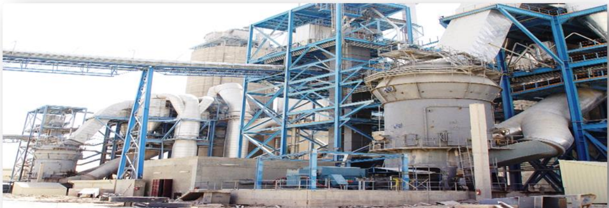
Figure.12. Broyeur ATOX de la matière crue [71].
