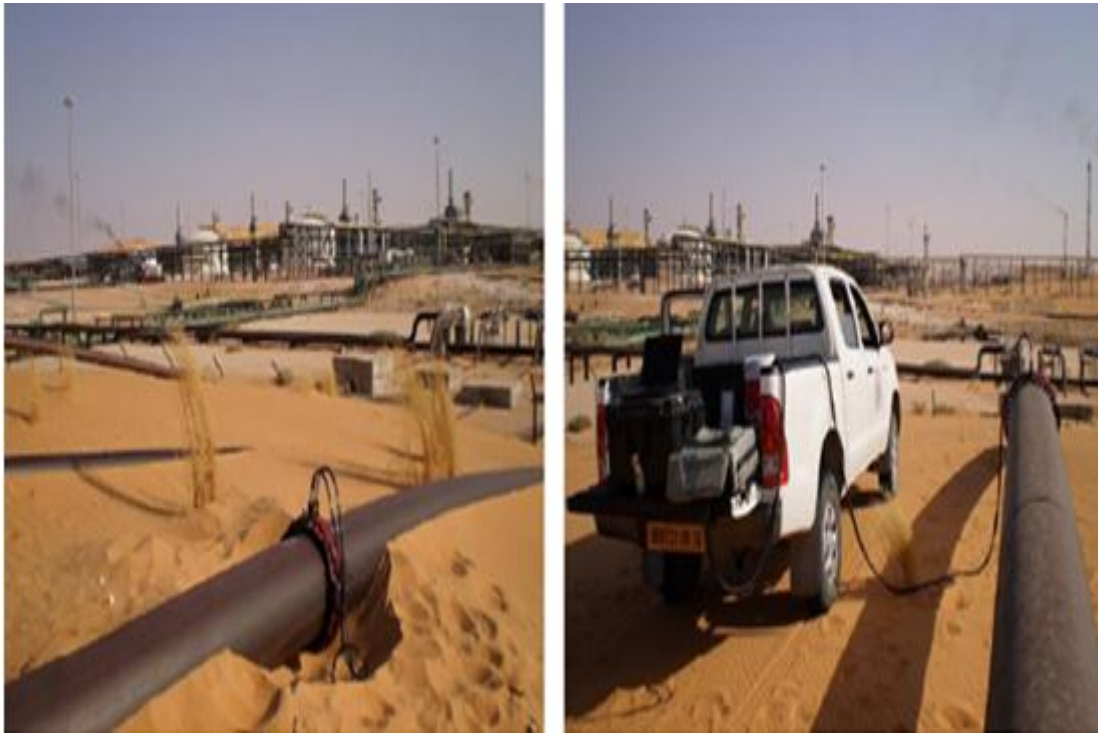
Figure(4.6): détection la corrosion réalisée avec LRUT.
