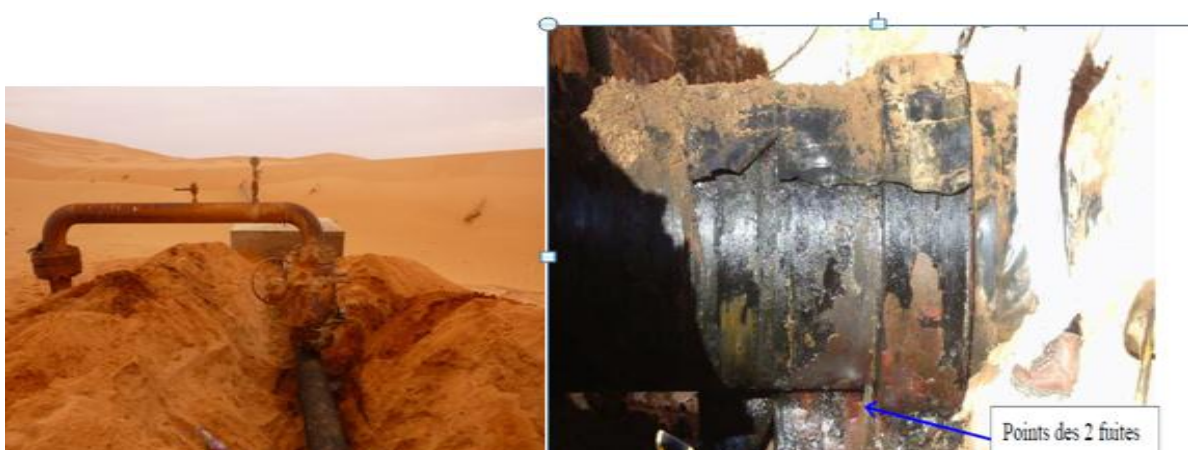
Figure(4.1): La corrosion externe d'une conduite enterrée
