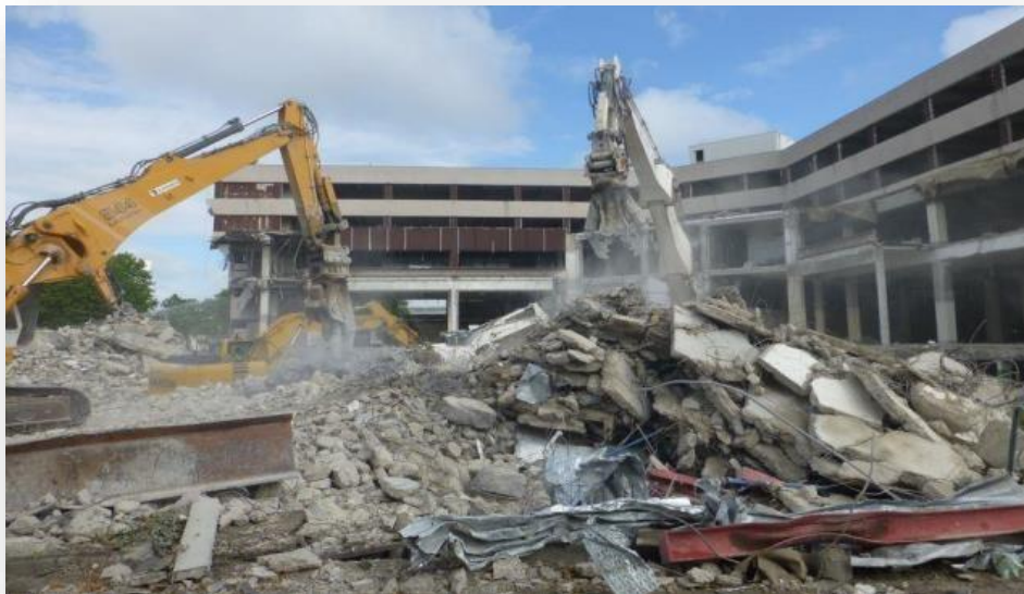
Figure III.18 : Déchets de la construction/ démolition.
