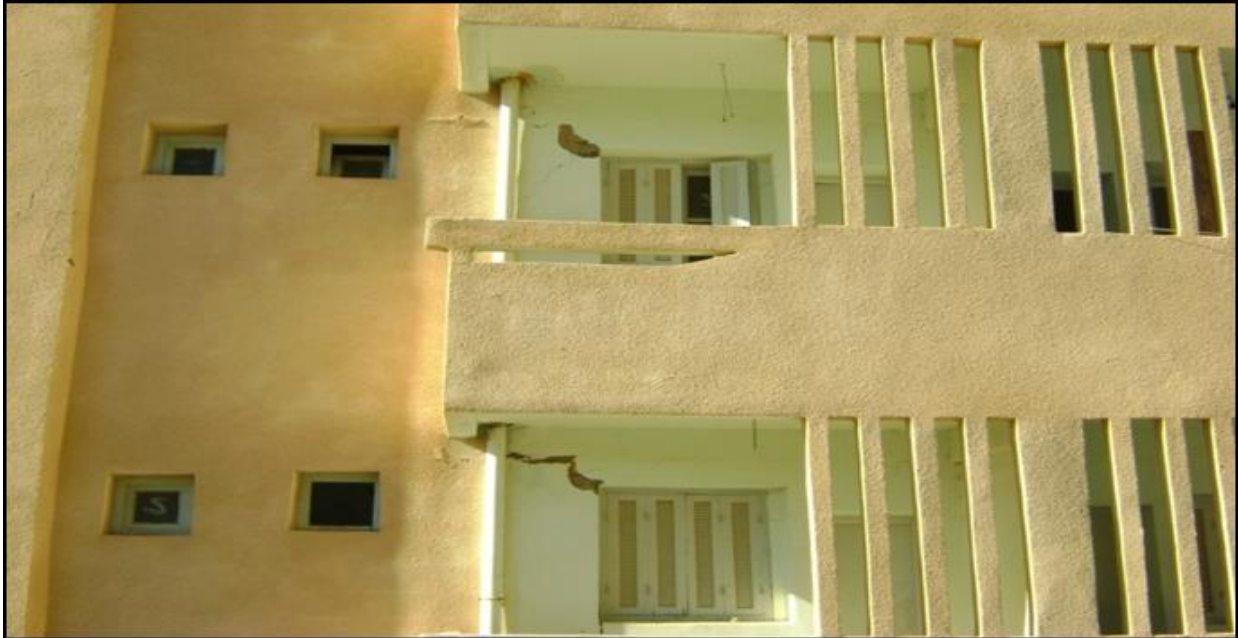
Photo 18 Fissures apparentes sur les balcons
