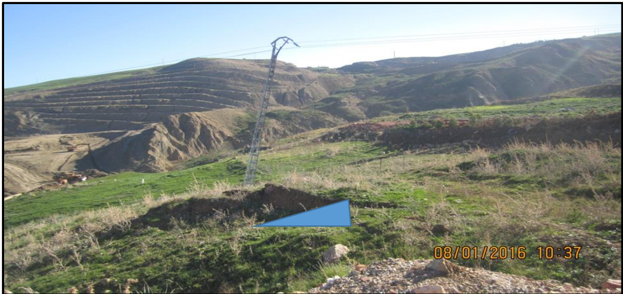
Photo 1 Exemple des Glissement en plan le poteau incliné en témoigne, limite Est PDAU-Mila
