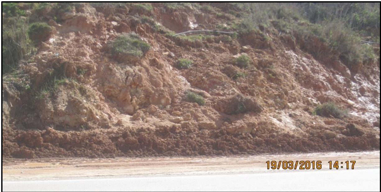
Photo 3 Exemple de coulée argileuse sur un talus de route .Contournement Nord Est Mila
