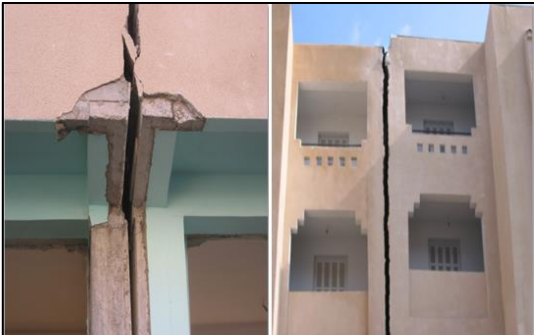
Photo 17 Dilatation des joints des deux derniers blocs affectant tout la hauteur du bâtiment et se prolonge jusqu'aux longrines non visibles sur la photo
