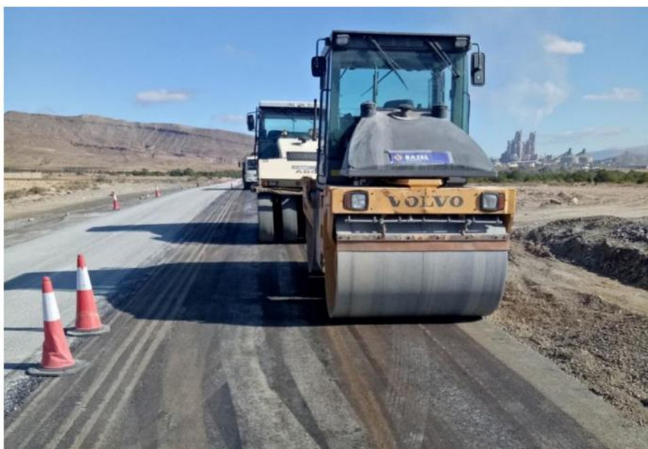
Figure I.3 : Mise en place d'un BCR routier (la route reliant entre la RN 45 et la cimenterie de M'sila - Algérie).
