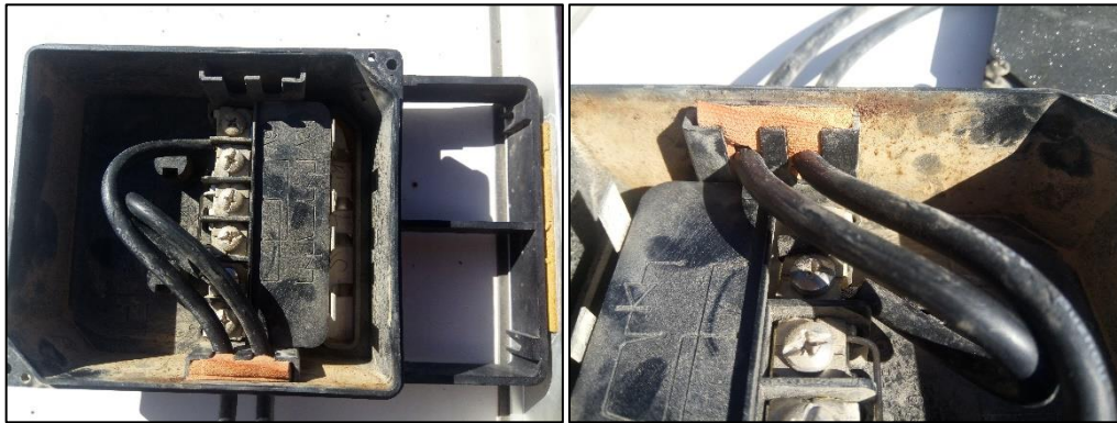
Figure I. 18: Défaillances de la boîte de jonction.
