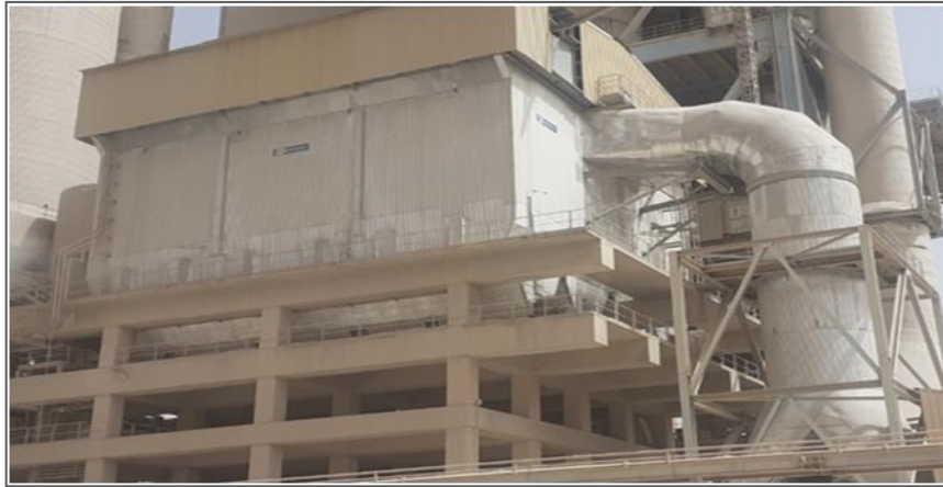
Figure 11. Vue du filtre en tissu a l'usine de ciment Lafarge.
