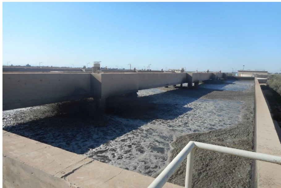
Figure II-12 : le bassin d'aération
