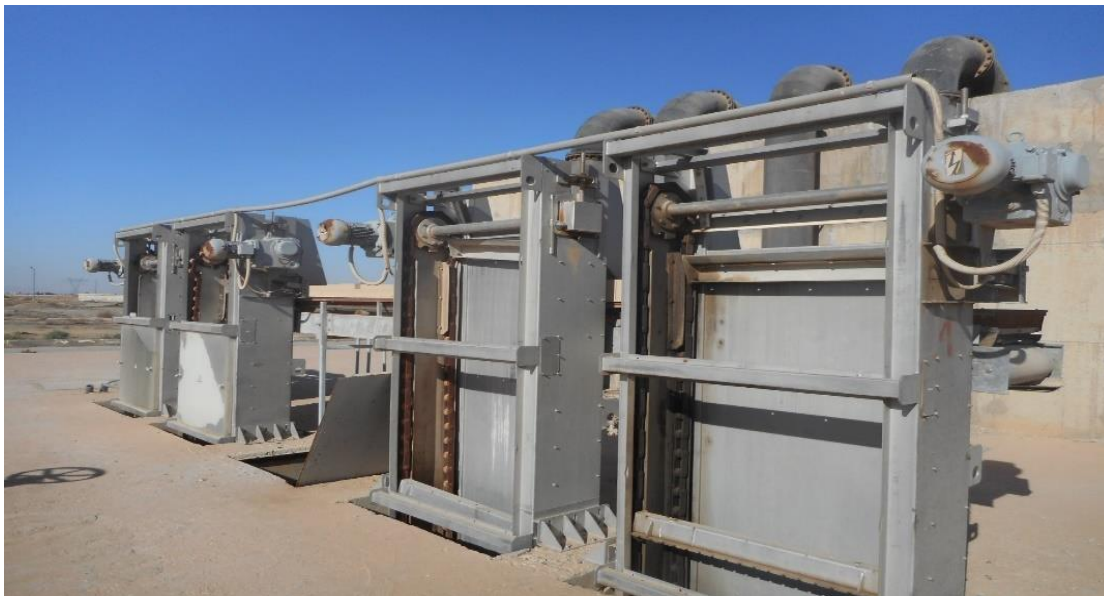
Figure II-8 : Dégrilleur grossier de la STEP de M'sila
