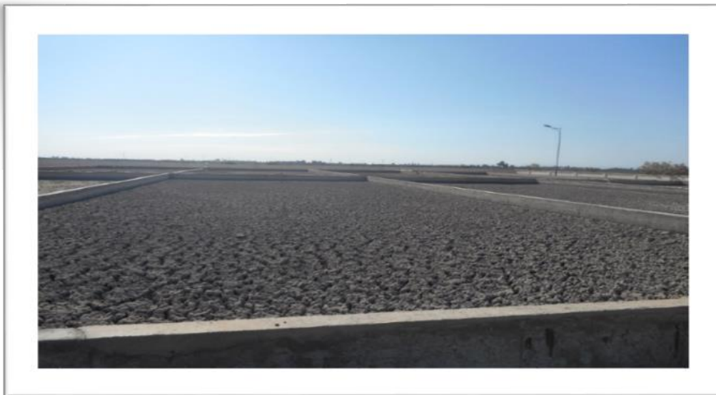
Figure II-15 : Les boues en excès déshydratées
