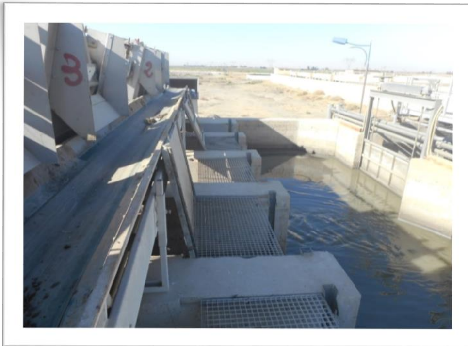
Figure II-9 : Dégrilleur fin de la STEP M'sila.
