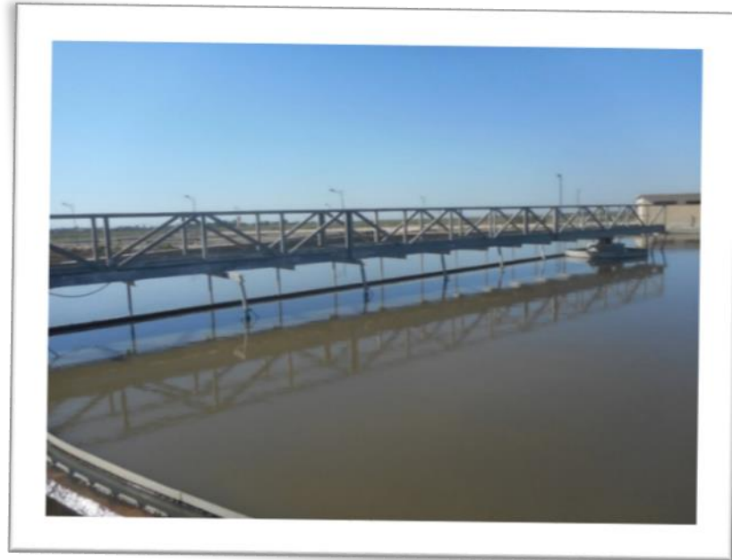
Figure II-13 : Clarificateur de la STEP de la ville de M'sila
