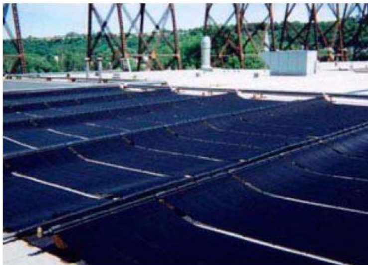
Figure I. 14 : Capteur moquette pour le chauffage des piscines.
