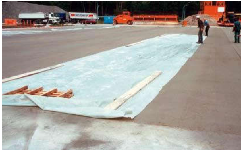
Figure.I.3.Bâche de protection contre la pluie [10].
