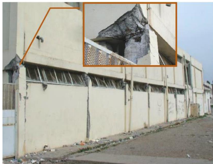
Figure I.2.13: Cas de poteaux courts sans protection – tous les poteaux sont cisailés [32].
