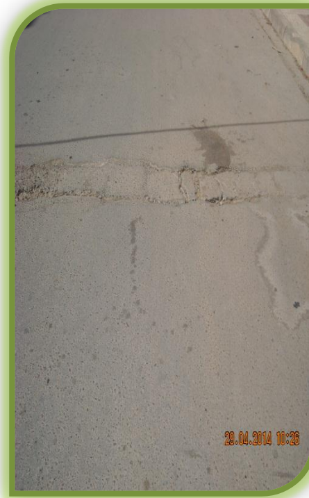
الصورة(31):طريق ثانوي مهترء
