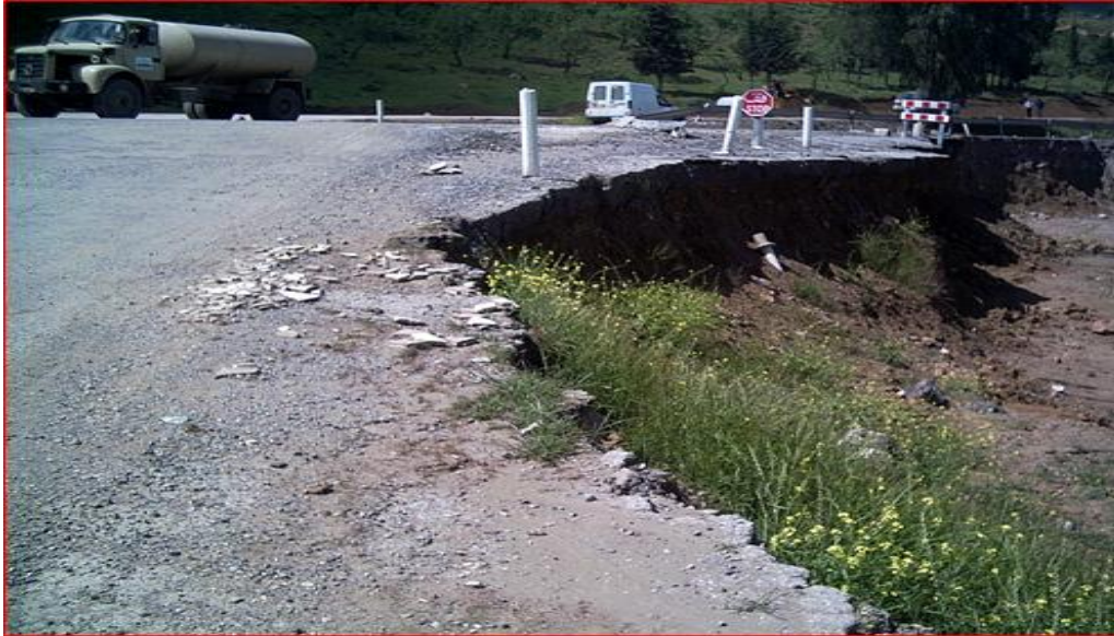
Figure 4. 2. : Affaissement et glissement du remblai routier
