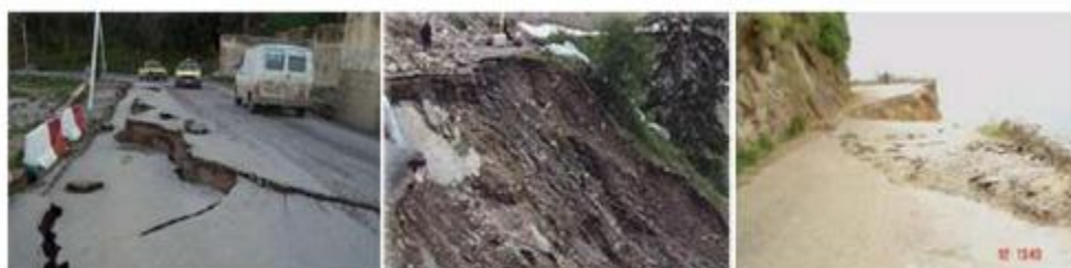
Figure 1. 17 : Instabilités des talus (cas des routes).
