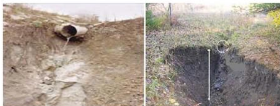
Concentration d'eau (érosion verticale). Concentration d'eau (ravinement)
