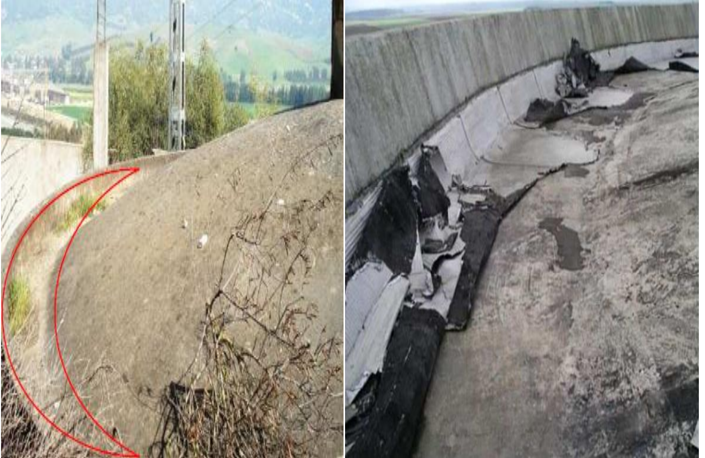
Figure (II.8) : l'étanchéité de la coupole (mauvaise état de l'étanchéité)
