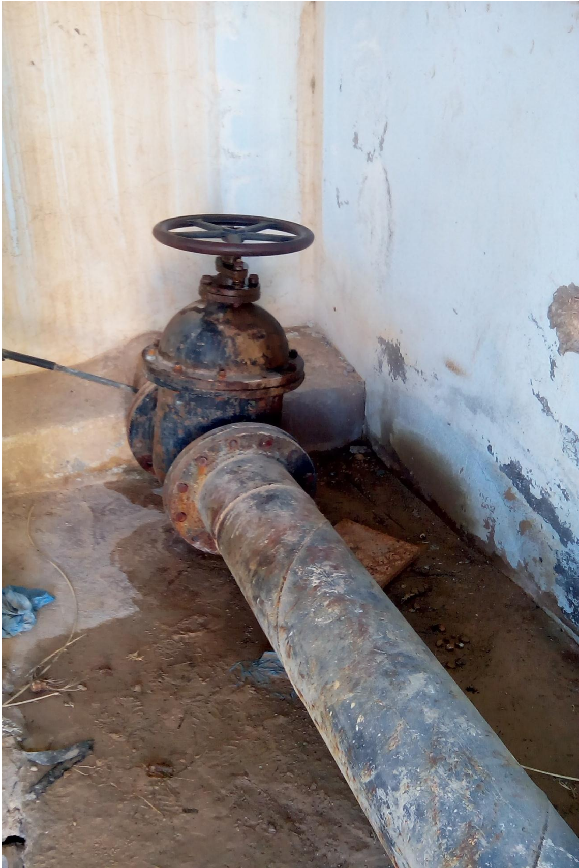
Figure (I.4.1) : Conduite de distribution photo réel de réservoir de notre étude
