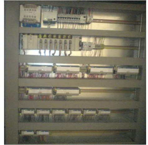
Figure I.4 : Armoire de commande à logique programmable "SCHNEIDER".
