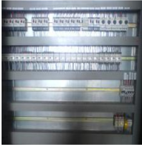
Figure I.3 : Armoire de commande à logique Câblée.
