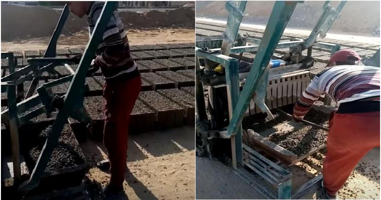
Fig (II.2) : La fabrication de Parpaing dans une usine du quartier (Maitar de « Bou-Saadâ »).
