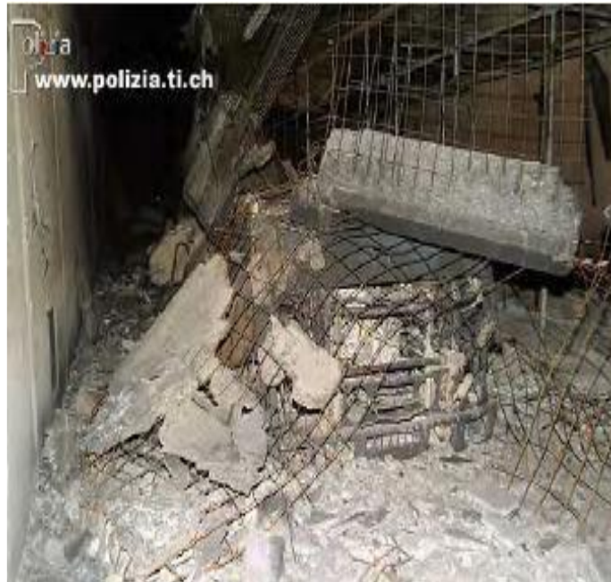
Fig. III. 2 : Section effondrée du faux plafond dans le tunnel du Gothard après l'incendie du 21 octobre, 2001
