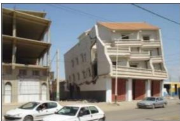
Figure I.10: Destruction par cisaillement du poteau court, poteau endommagée par le séisme de Boumerdes, Algérie. [4]
