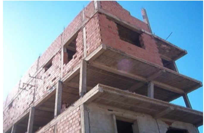
Figure I.6: Cisaillement des poteaux d'une construction à Bordj el bahri. Séisme de 2003, Boumerdes, Algérie. [3]
