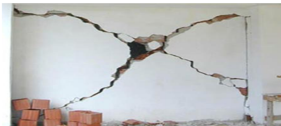
Figure I.8 : Des endommagements à cause de remplissage partiel. [3]
