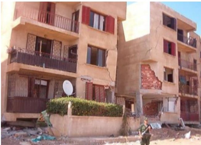
Figure I.2 : Destruction du RDC. [3]
