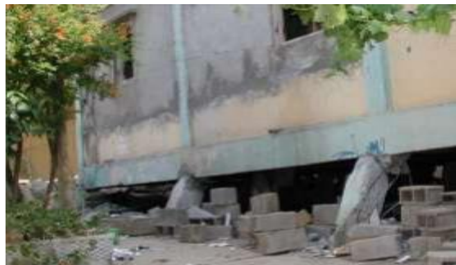
Figure I.11: Détail de destruction des poteaux à cause du fonctionnement en "poteaux courts" [1].
