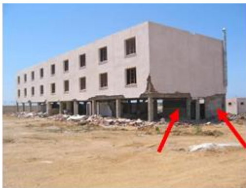
Figure I.15 : effondrement totale de la maçonnerie niveau du R.D.C [4]
