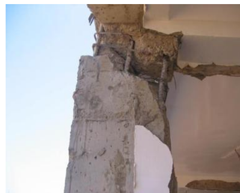
Figure I.16 : éclatement du noeud au niveau de la tête du poteau du R.D.C[4]
