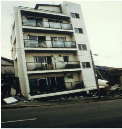
Figure I. 8: Le rez-de-chaussée s'est effondré entièrement Murs en béton armé- Great Hanshin, Japon 1995 / Kobe[5]
