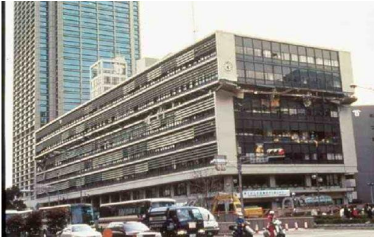
Figure I. 4: Perte d'un étage de la mairie de Kobe (Séisme de Kobe (Japon) en 1995). Cet étage marquait une transition entre des poteaux métalliques (remplis de béton) et des poteaux en Béton Armé. [5]
