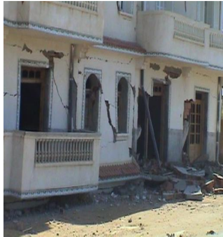
Figure I.9 : disparition du rez de chaussée (RDC est effondré complètement (étage souple)), Zemmouri ville – Séisme de 2003, Boumerdes, Algérie [5]
