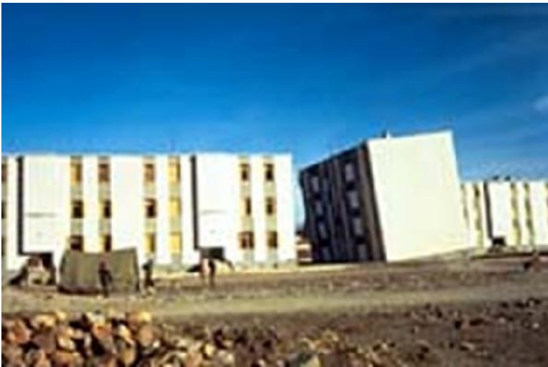
Figure I. 5: Bâtiment d’habitation de 3 étages, ( EL Asnam, Algérie), est endommagé par le séisme de 1980 d’EL Asnam[5]
