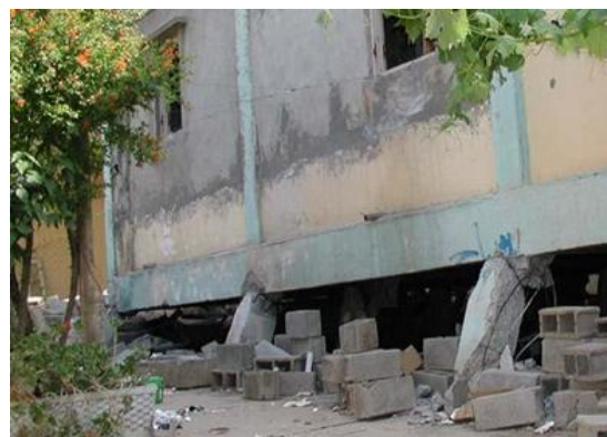
Figure I.11: Dommages dus à l'effet de poteau court en vide sanitaire [4]
