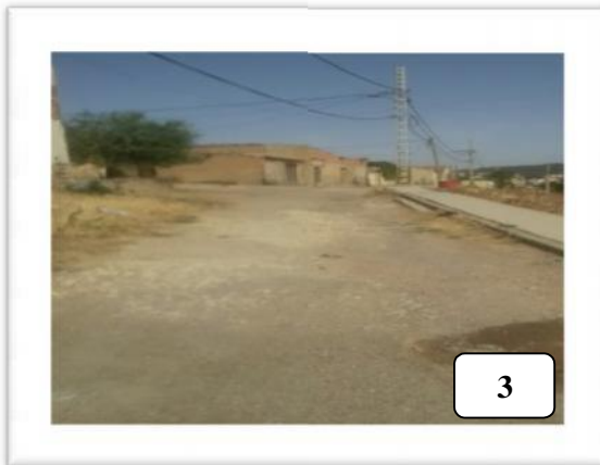
Voie en mauvais état
