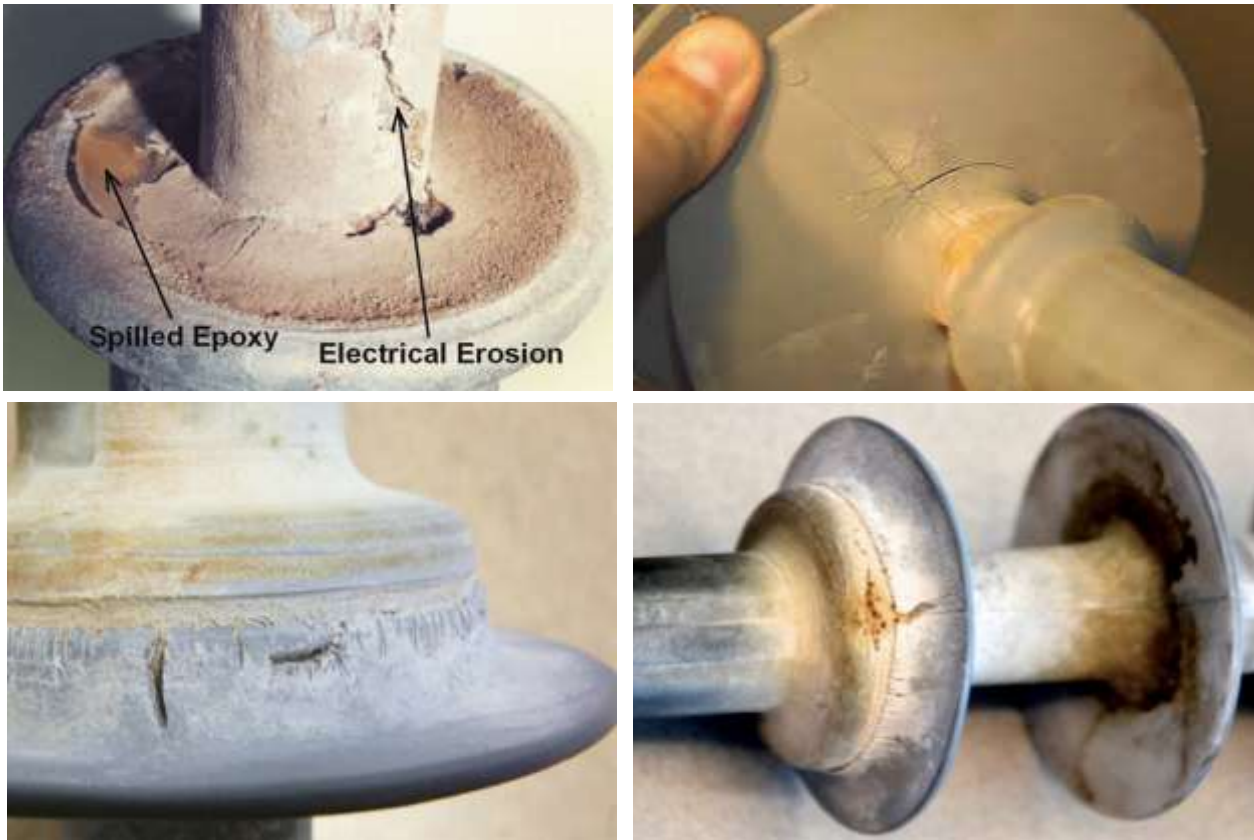
Figure II. 5. Dégradation de l'isolateur composite
