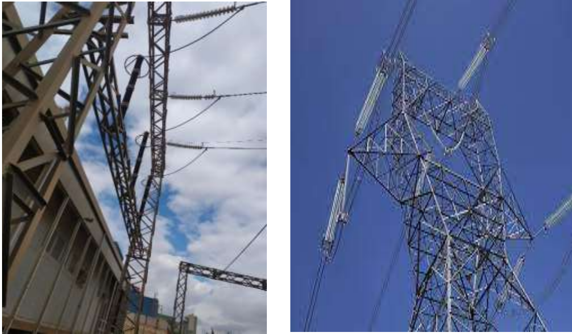
Figure II. 1. Isolateurs composites sur une ligne électrique
