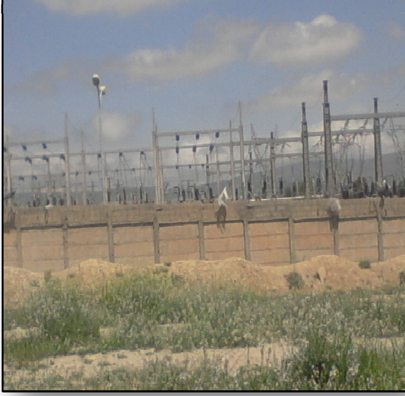
صورة رقم: 21 مولد كهرباء المدينة
