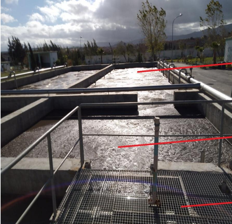
الصورة رقم(04): أحواض الحوض البيولوجي
