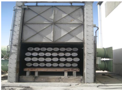
Figure I.7 : chambre de refroidissement .
