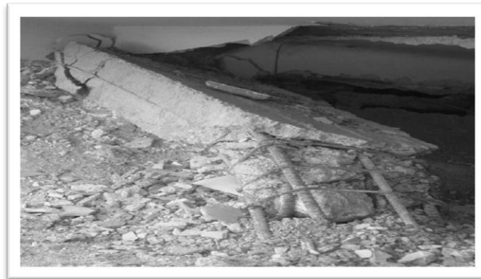
Figure.3.18 : Arrachement des armatures recouvertes en zone nodale après plastification[12]
