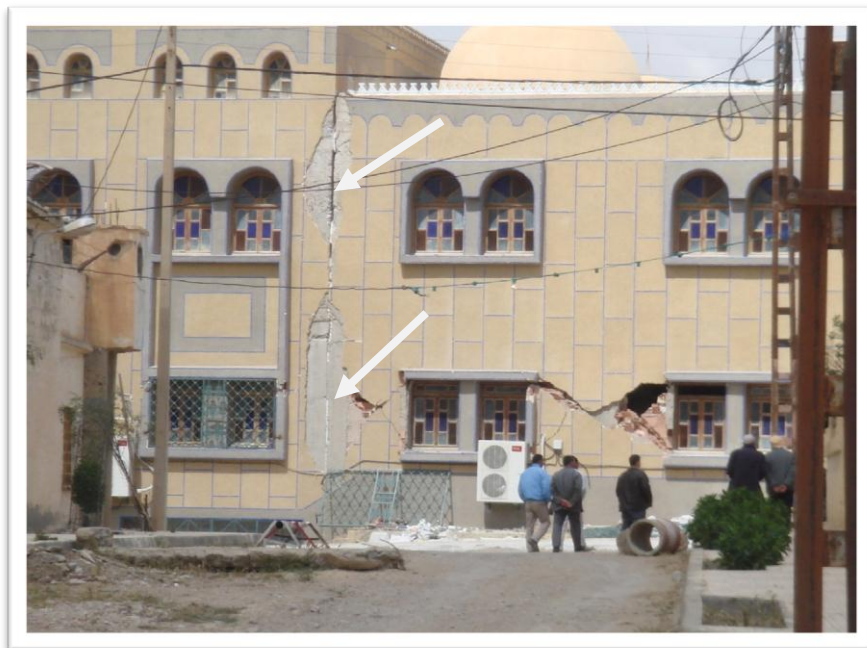
Figure 3.16 : Grande mosquée de Béni Ilmène ; entrechoquement de blocs pour cause de joint trop étroit au regard des déplacements réels. [13]
