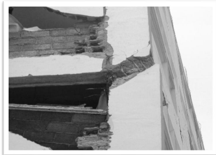
Figure.3.6 :Rupture par cisaillement due à l'interaction maçonnerie portique, le centre de Boumerdes [12] .
