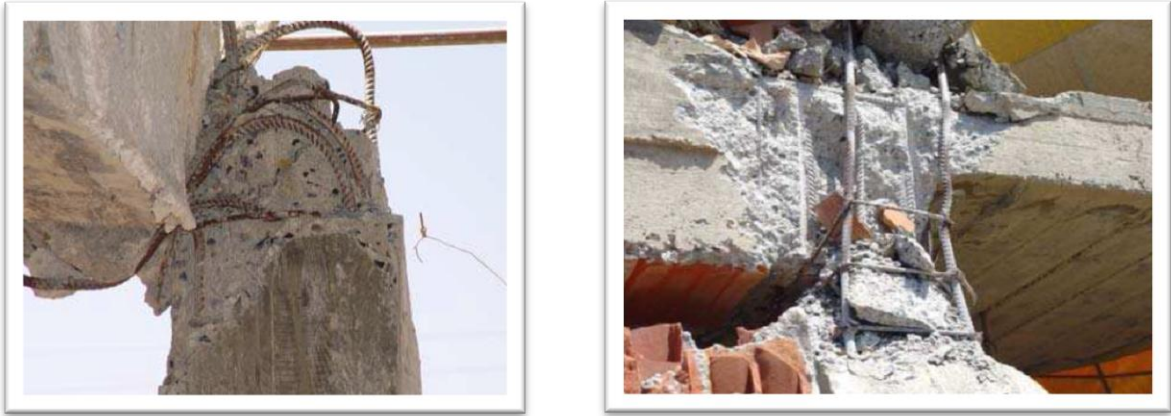
Figure 3.20 : Ruines dues à l'absence des cadres d'armature transversale au nœuds.. [12]
