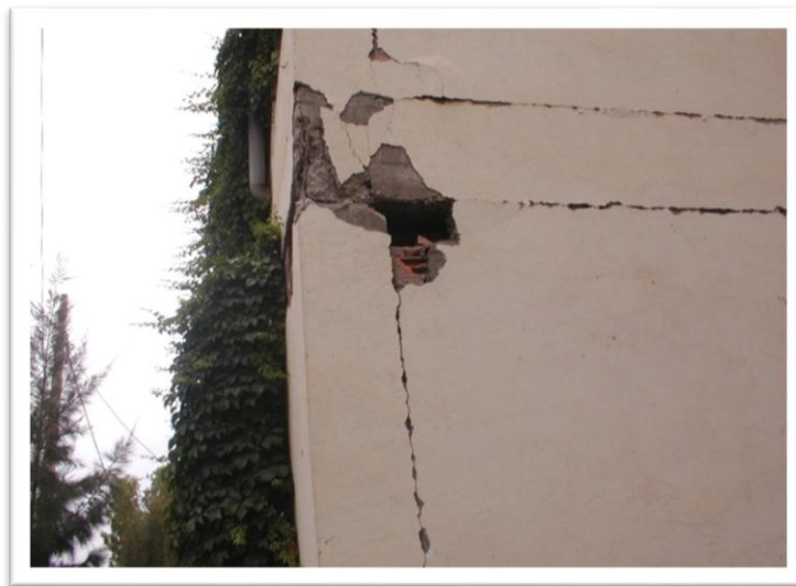
Figure.3.7 : Ruptures fragiles aux niveaux des éléments structuraux, le centre de Boumerdes[12] .
