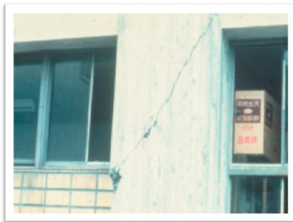
Figure. 3.12: Poteau bridé d'un côté : une seule fissure diagonale a été provoquée, correspondant à la déformation du poteau vers l'allège. Dans le sens de la porte vitrée[28] .
