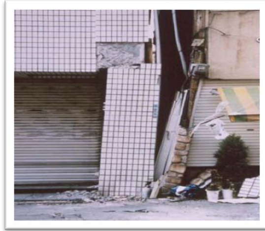
Figure 3.13 : Entrechoquement de bâtiments pour cause de joint PS trop étroit au regard des déplacements réels.
