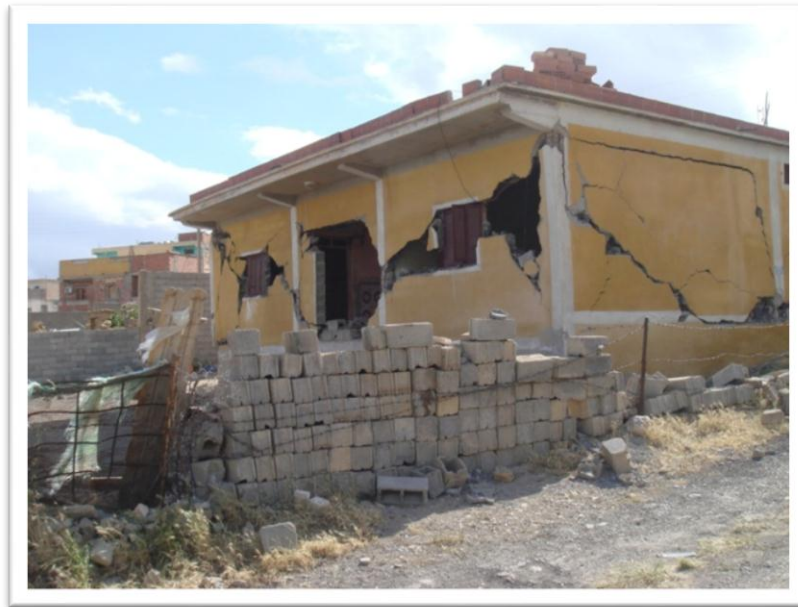
Figure.3.8. Effondrement des murs d'une structure autostables avec maçonnerie insérée, Béni Ilmène2010[13].
