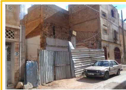
الصورة رقم(103) تدهور الواجهة العمرانية
