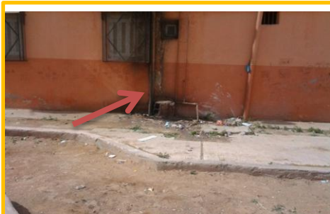
الصورة رقم(77) تلوث الهواء الناتج عن رائحة البالوعات
