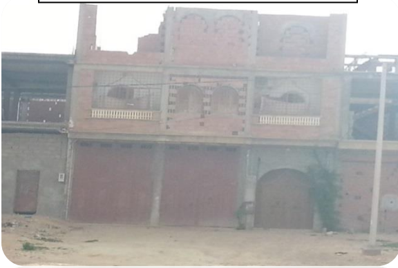
الصورة رقم (21):سكن فردي حالة رديئة
