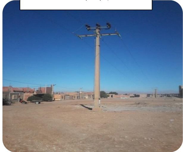
الصورة رقم (60): عمود الكهرباء
