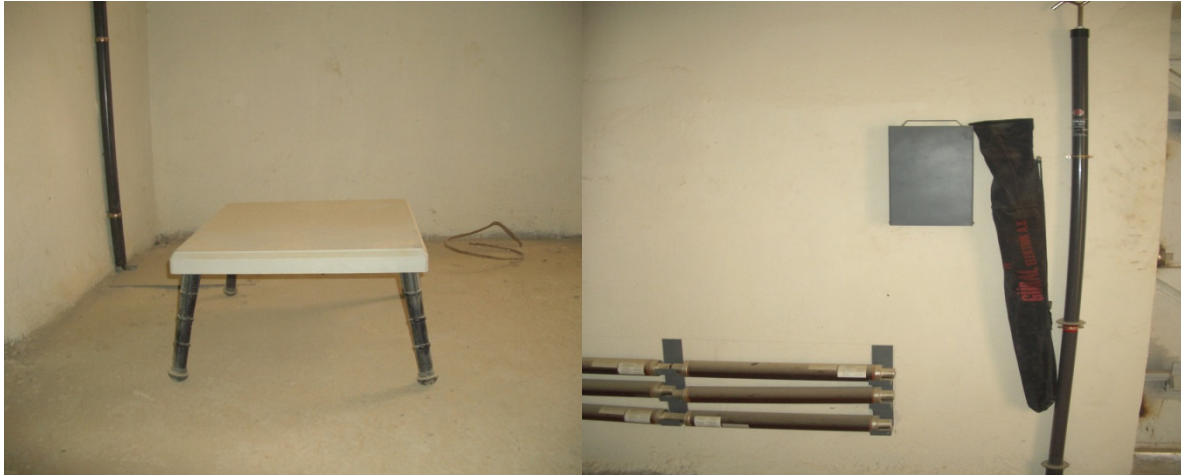
Figure (III.9) Équipements de sécurité.
