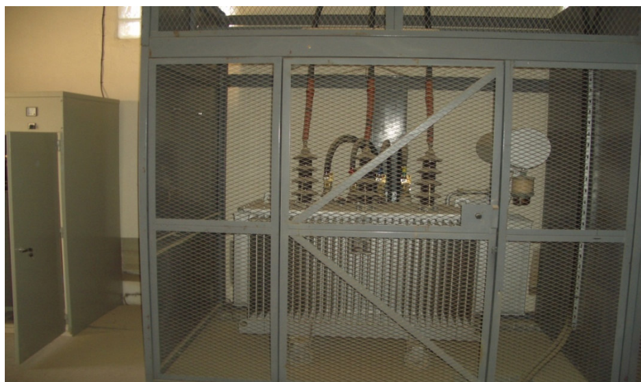
Figure (III.7) transformateur de puissance.
